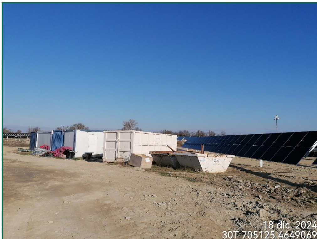
Fotografía 11. Contenedores para residuos inertes.
