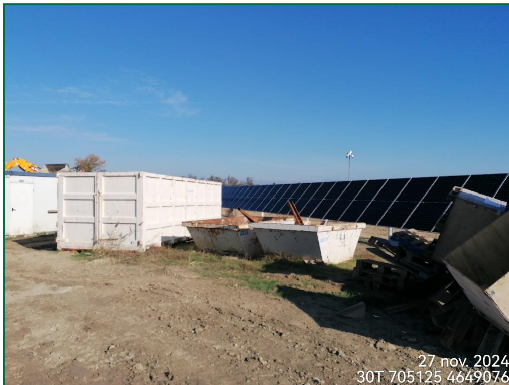
Fotografía 10. Contenedores para residuos inertes.
