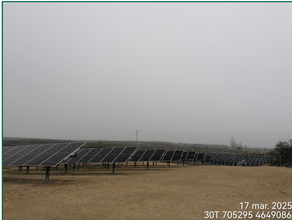
Fotografía 2. Superficie de la PFV.
