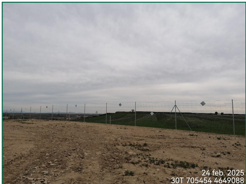
Fotografía 18. Placas anticolidión y pasos de fauna en el vallado perimetral.
