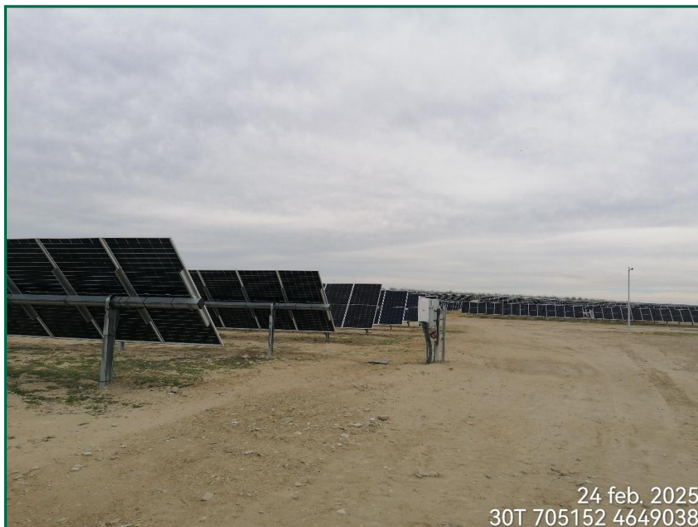
Fotografía 3. Superficie de la PFV.
