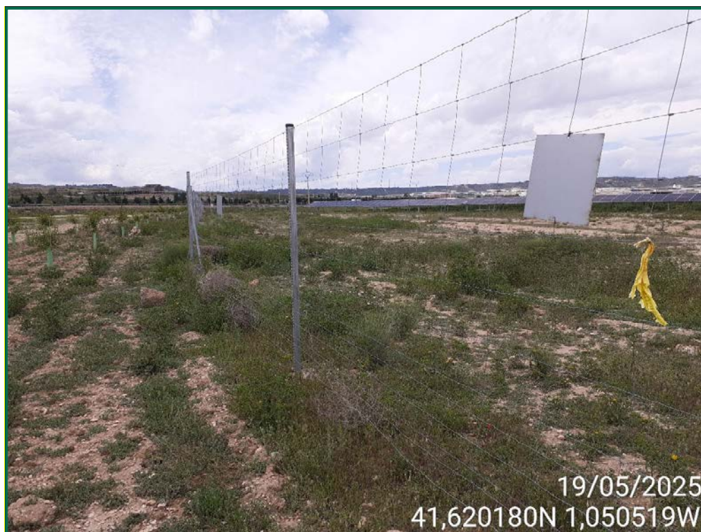
Fotografía 27. Placas anticolidión y vallado perimetral.
