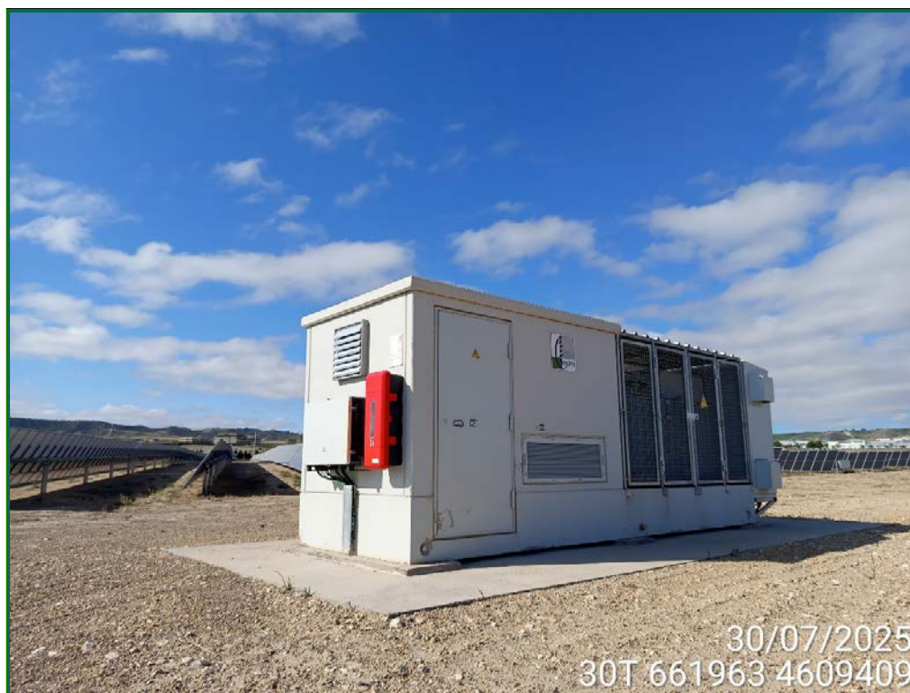
Fotografía 59. Extintor en la CT.
