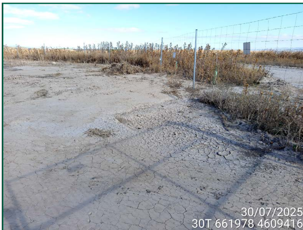
Fotografía 3. Zonas con erosión dentro de la planta fotovoltaica.
