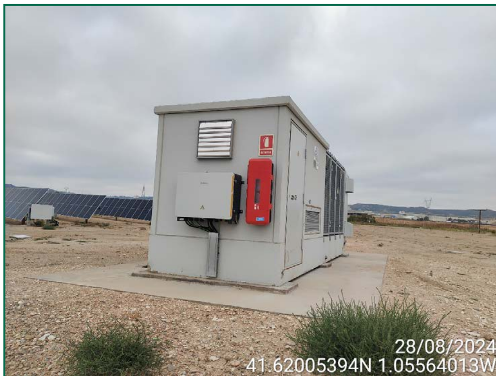
Fotografía 99. Extintor en la CT.
