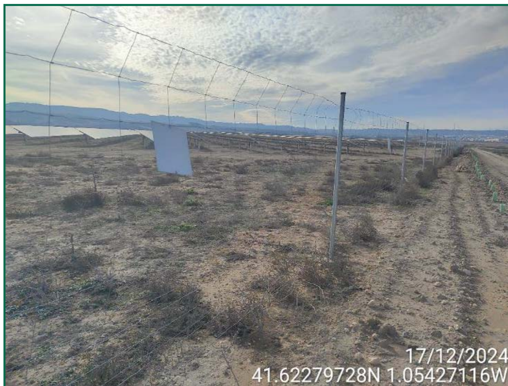
Fotografía 48. Placas anticollisión y vallado perimetral.
