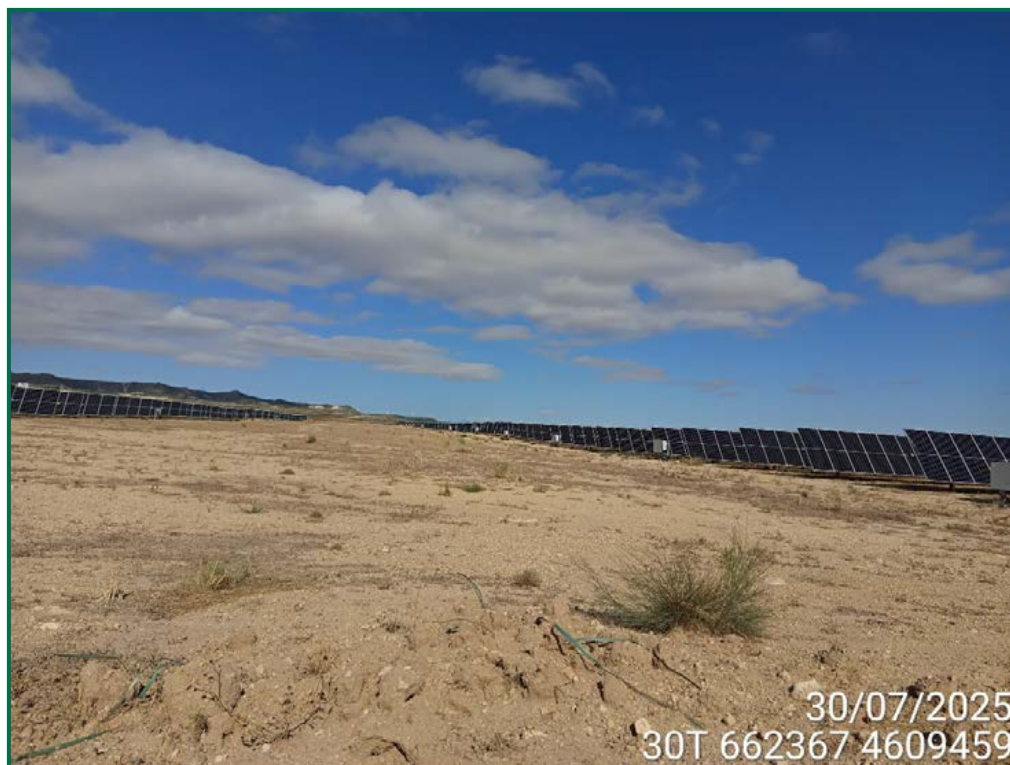
Fotografía 4. Superficie de la PFV.
