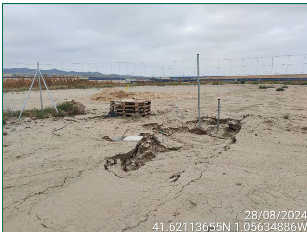
Fotografía 5. Zonas con erosión dentro de la planta fotovoltaica.
