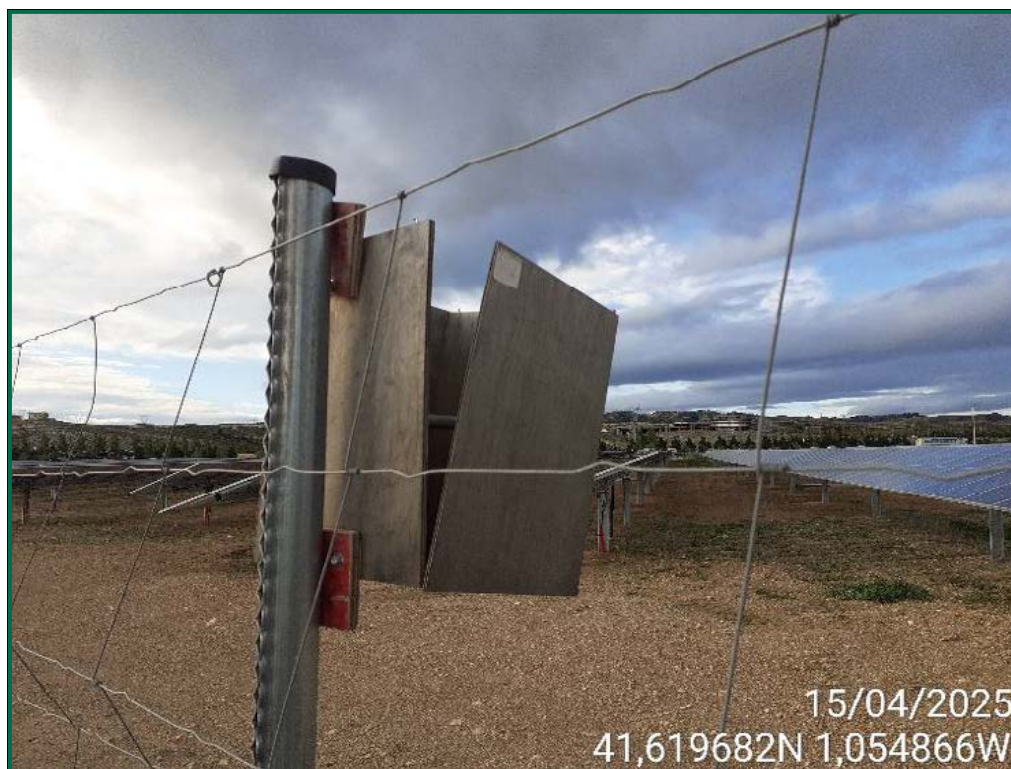
Fotografía 66. Caja nido deteriorada.
