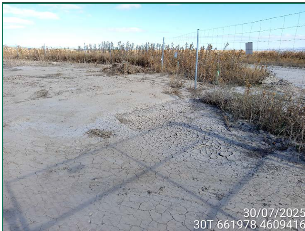
Fotografía 7. Zonas con erosión dentro de la planta fotovoltaica.
