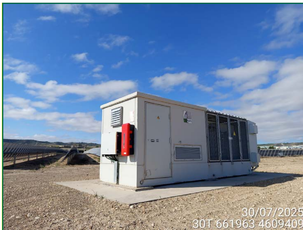
Fotografía 100. Extintor en la CT.
