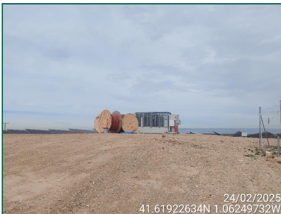
Fotografía 38. Restos de materiales.
