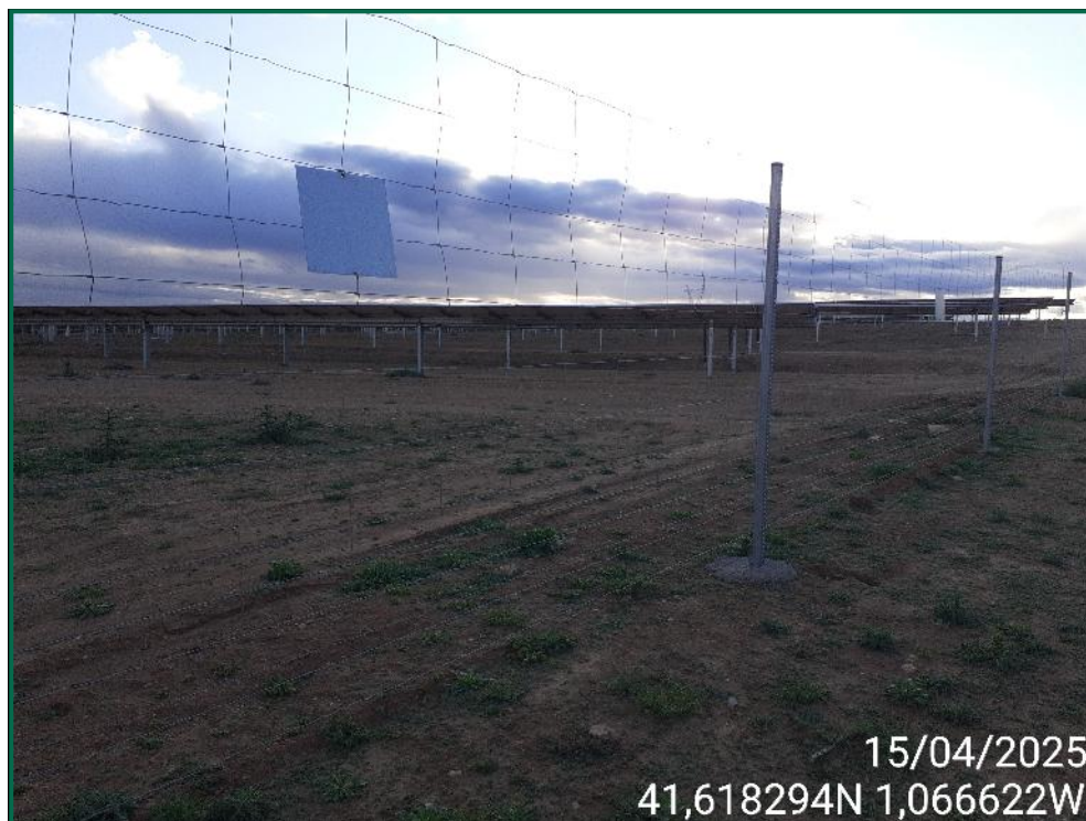
Fotografía 27. Placas anticolidión y vallado perimetral.
