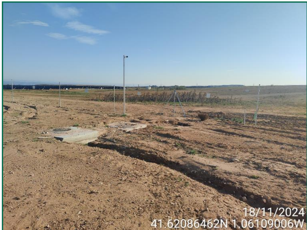
Fotografía 3. Zonas con erosión.
