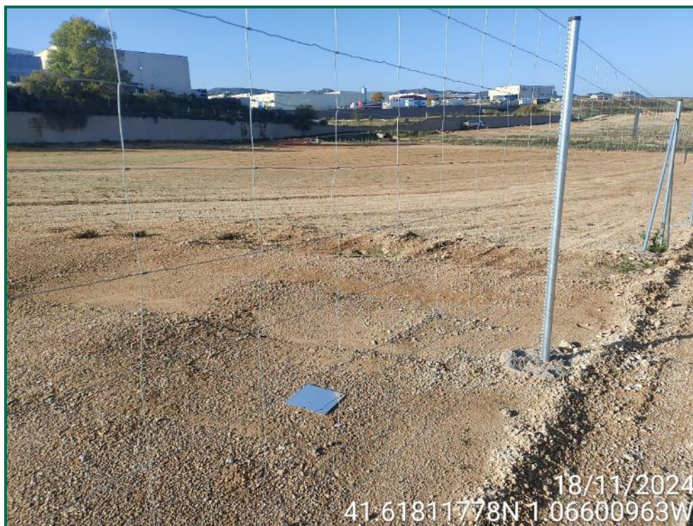
Fotografía 27. Placa anticolidión desprendida.
