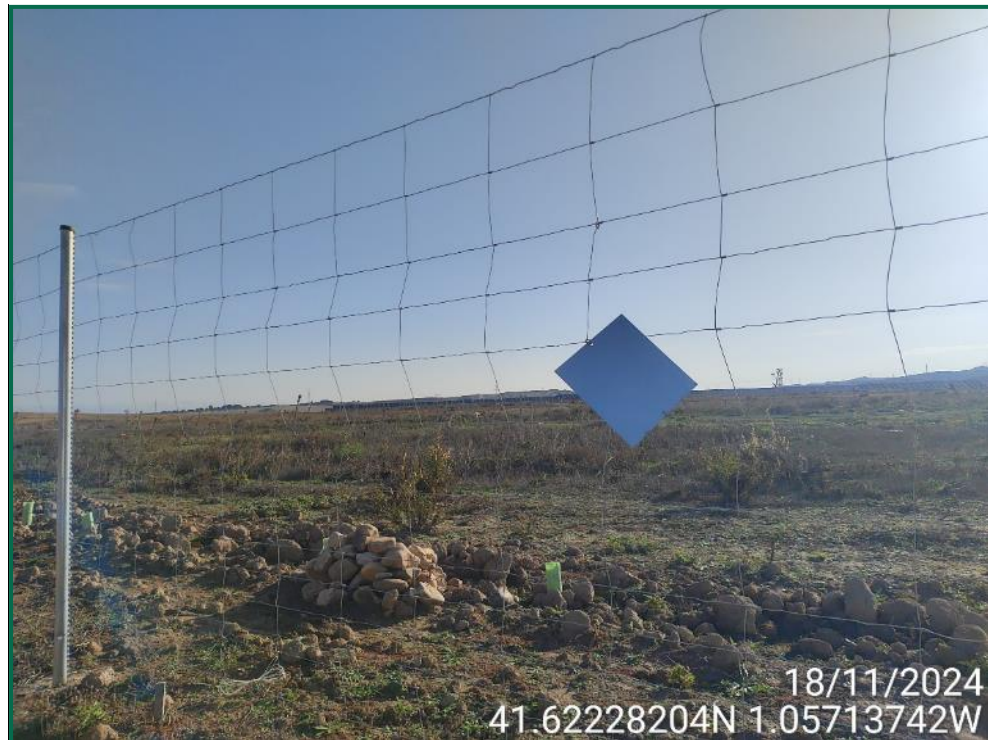
Fotografía 25. Placas anticollisión y vallado perimetral.
