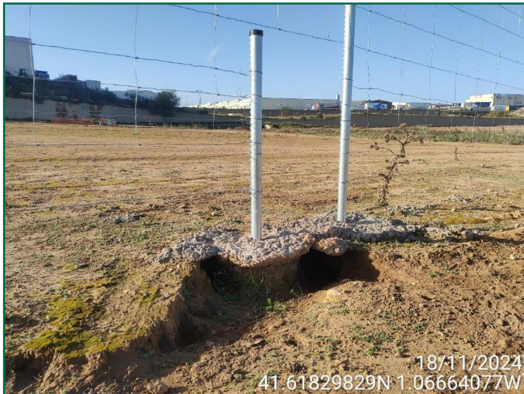
Fotografía 4. Madrigueras dentro de la planta fotovoltaica.
