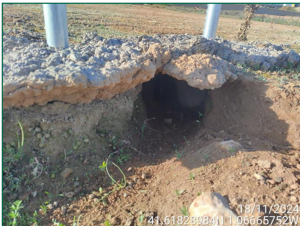
Fotografía 5. Madrigueras dentro de la planta fotovoltaica.
