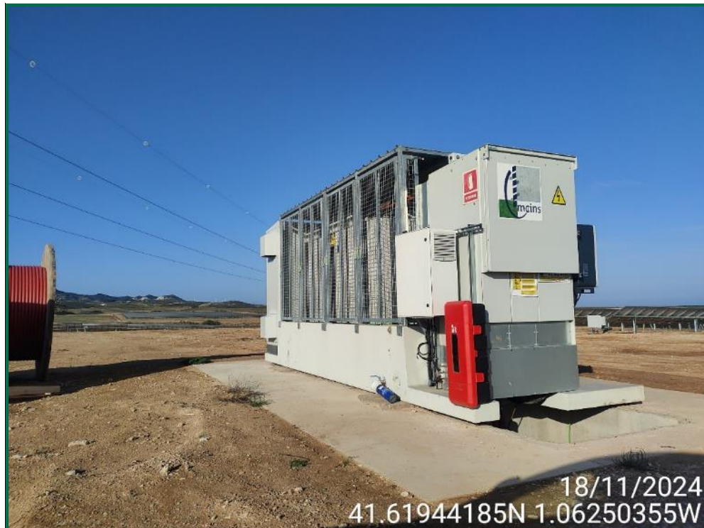
Fotografía 39. Extintor en la CT.
