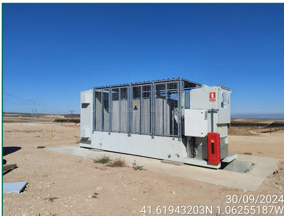
Fotografía 40. Extintor en la CT.
