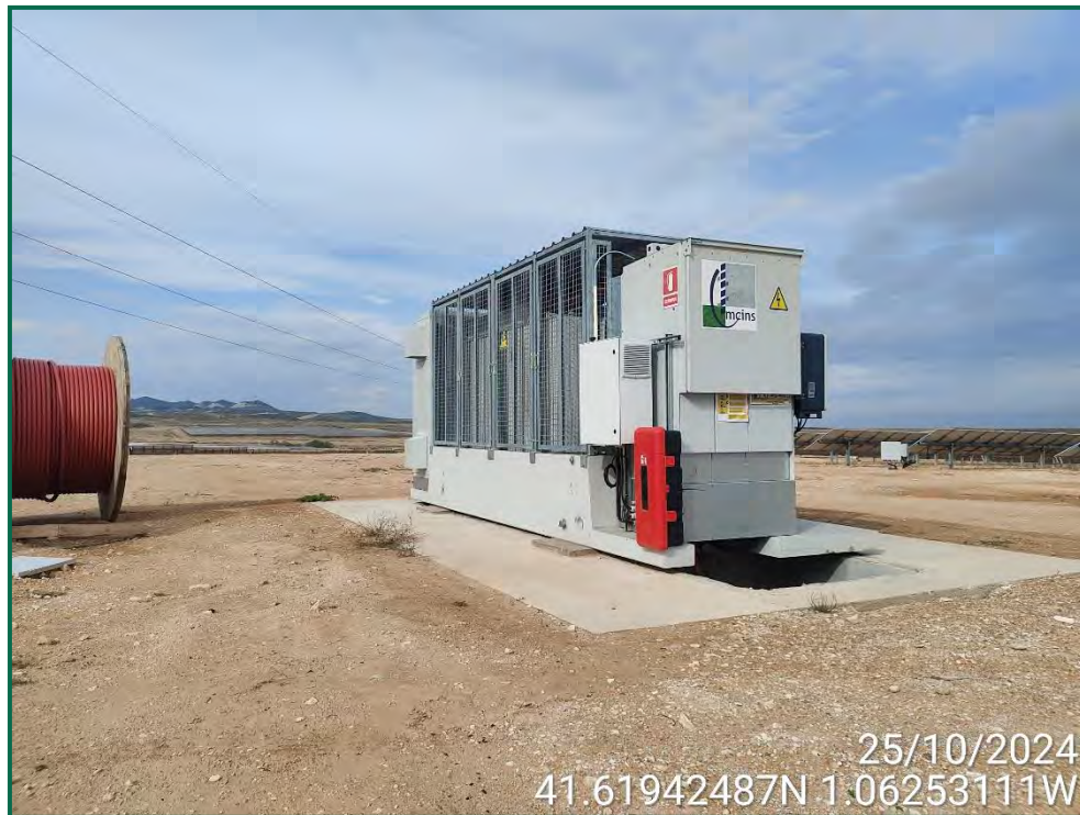
Fotografía 41. Extintor en la CT.
