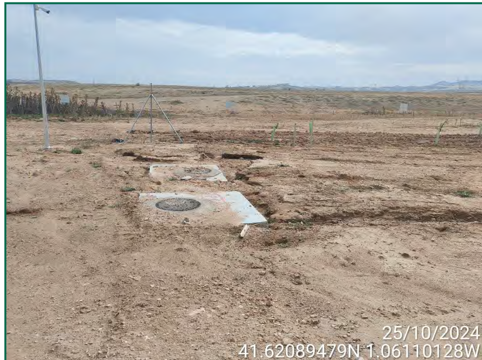
Fotografía 3. Zonas con erosión.
