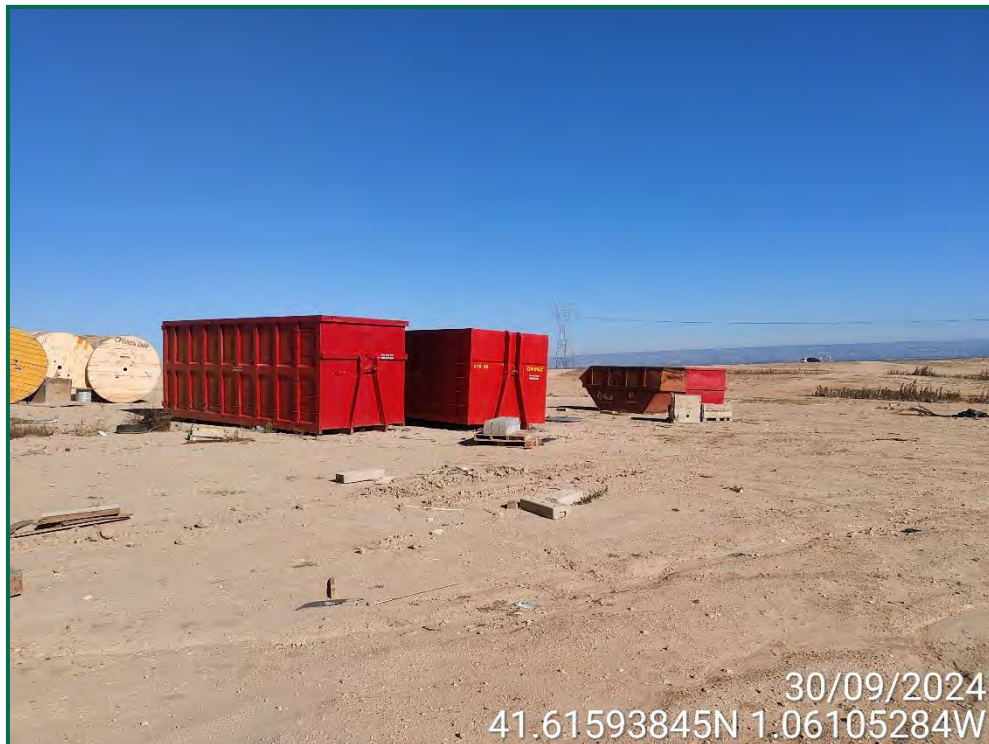
Fotografía 38. Contenedores de residuos.
