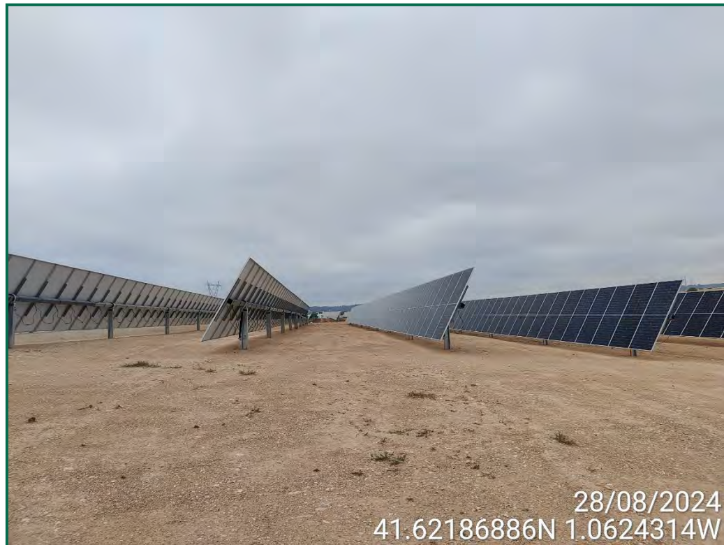
Fotografía 6. Zonas internas sin vegetación entre seguidores
