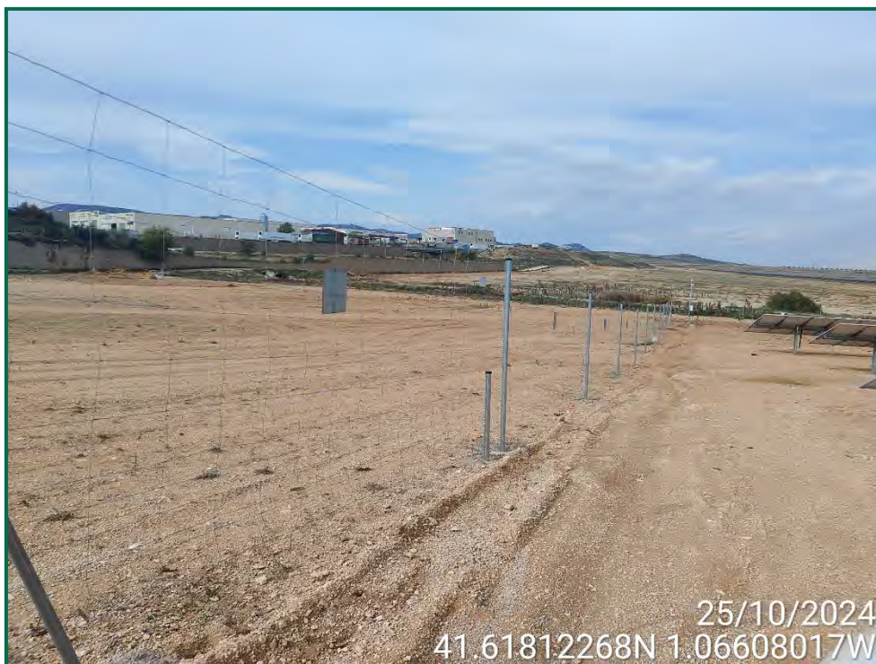
Fotografía 27. Placas anticollisión y vallado perimetral.
