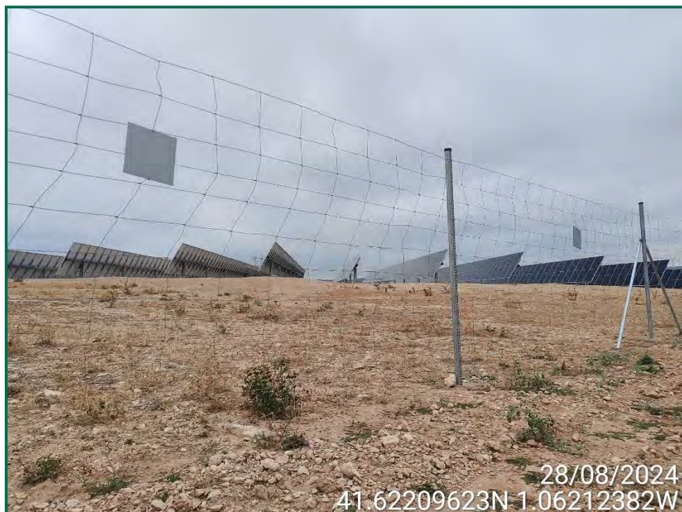
Fotografía 26. Placas anticolidión y vallado perimetral.
