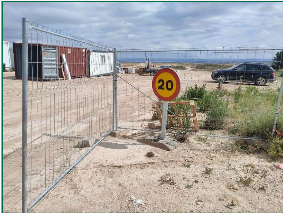
Fotografía 7. Señalización de velocidad.
