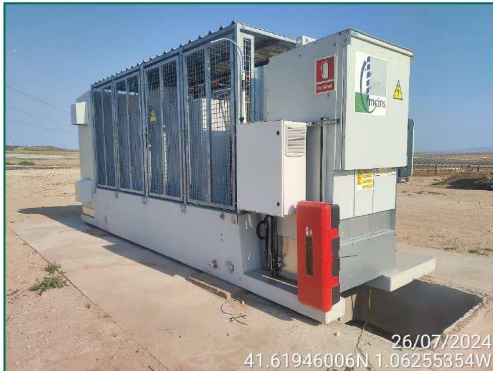
Fotografía 77. Extintor en la CT.
