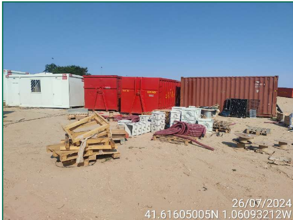
Fotografía 54. Contenedores de residuos y restos de materiales.
