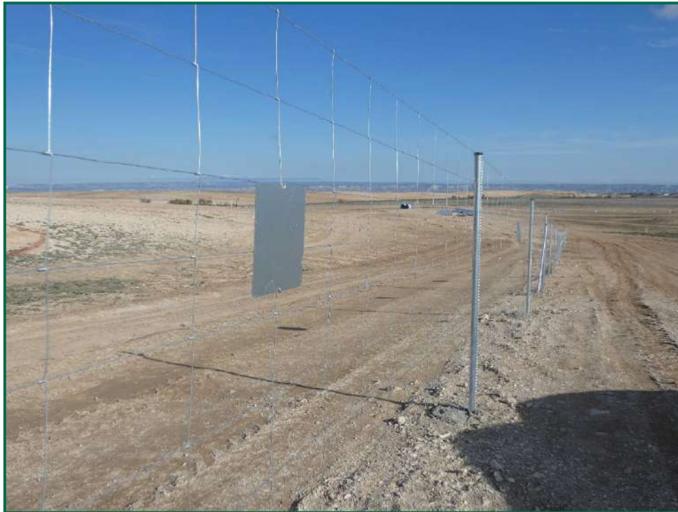
Fotografía 27. Placas anticolidión y vallado perimetral.
