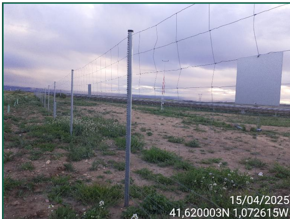
Fotografía 21. Placas anticolidión y vallado perimetral.
