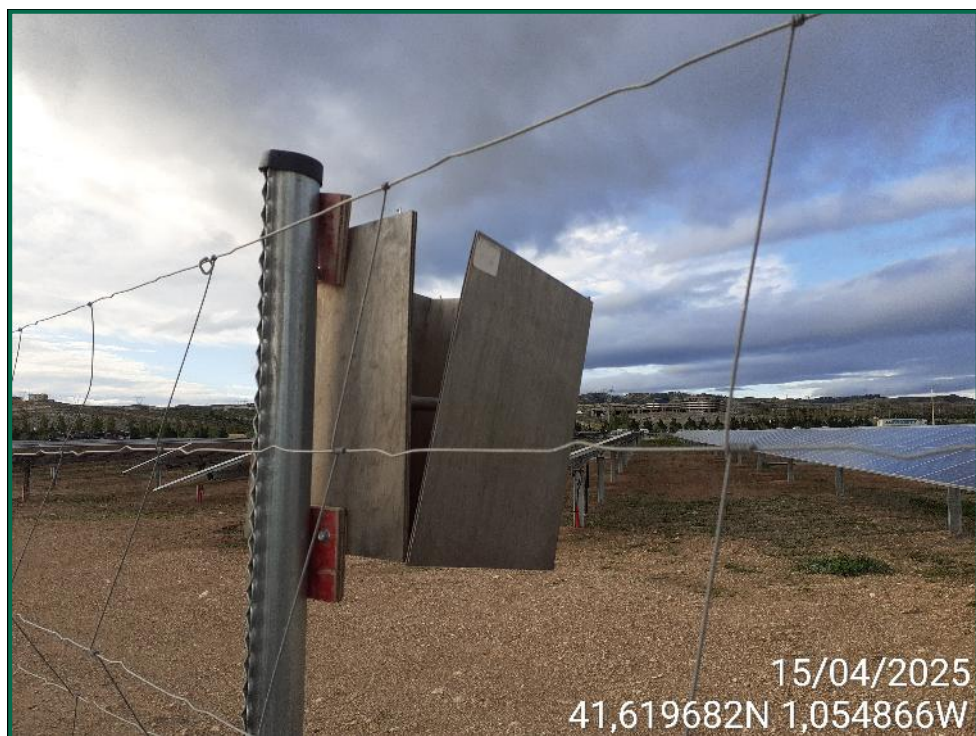
Fotografía 29. Caja nido deteriorada.
