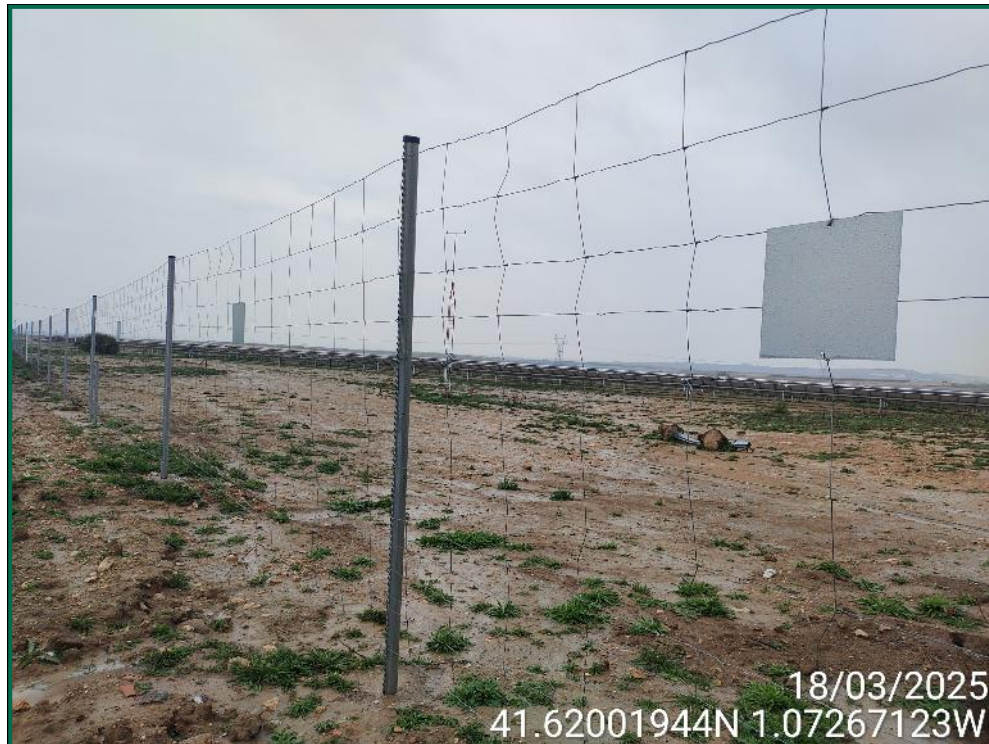
Fotografía 20. Placas anticolidión y vallado perimetral.
