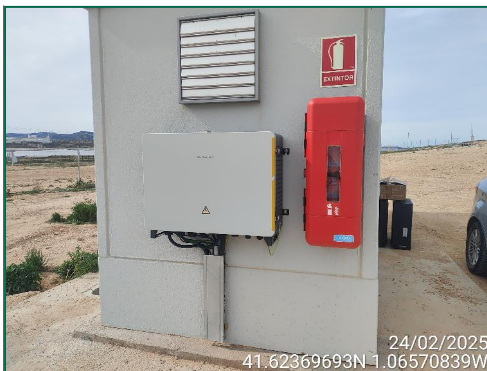
Fotografía 38. Extintor en la CT.
