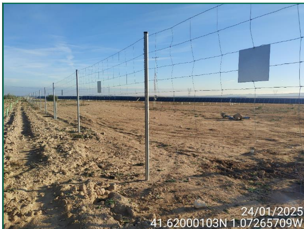
Fotografía 25. Placas anticollisión y vallado perimetral.
