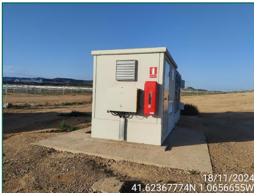
Fotografía 40. Extintor en la CT.
