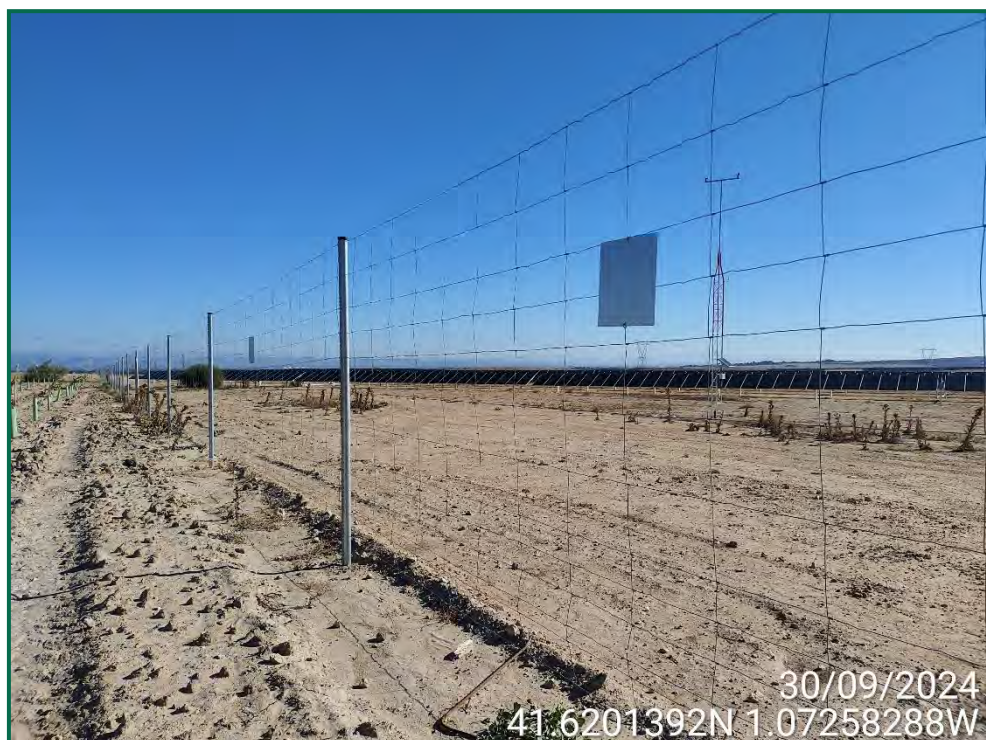
Fotografía 24. Placas anticollisión y vallado perimetral.
