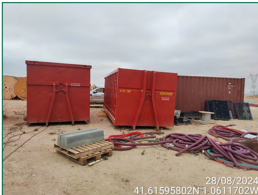
Fotografía 34. Contenedores de residuos y restos de materiales.
