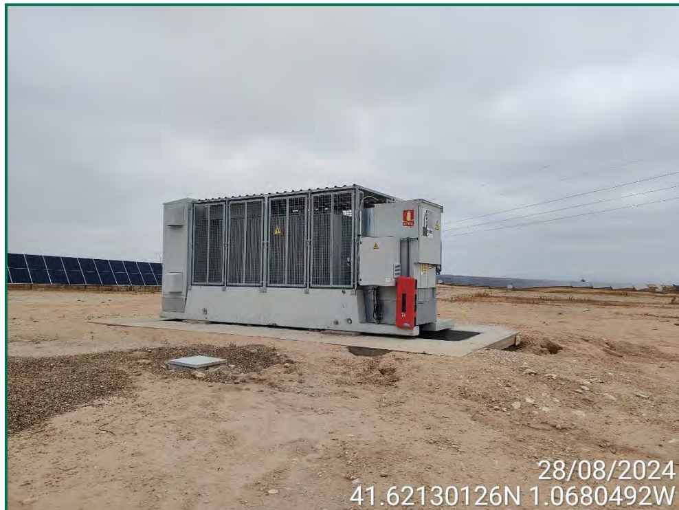
Fotografía 38. Extintor en la CT.
