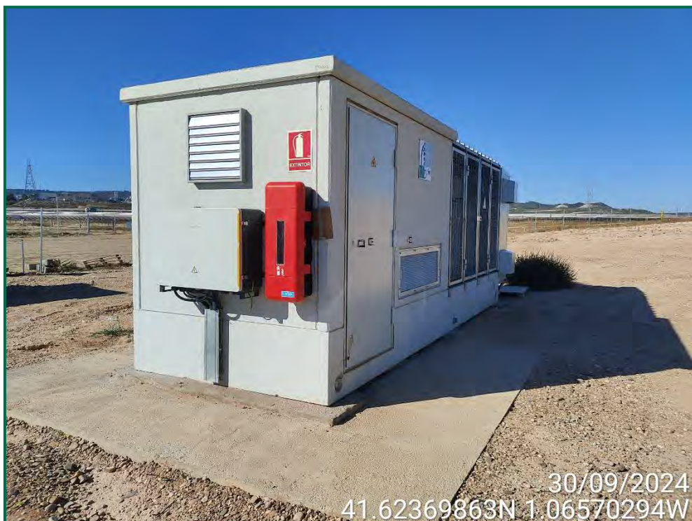
Fotografía 39. Extintor en la CT.
