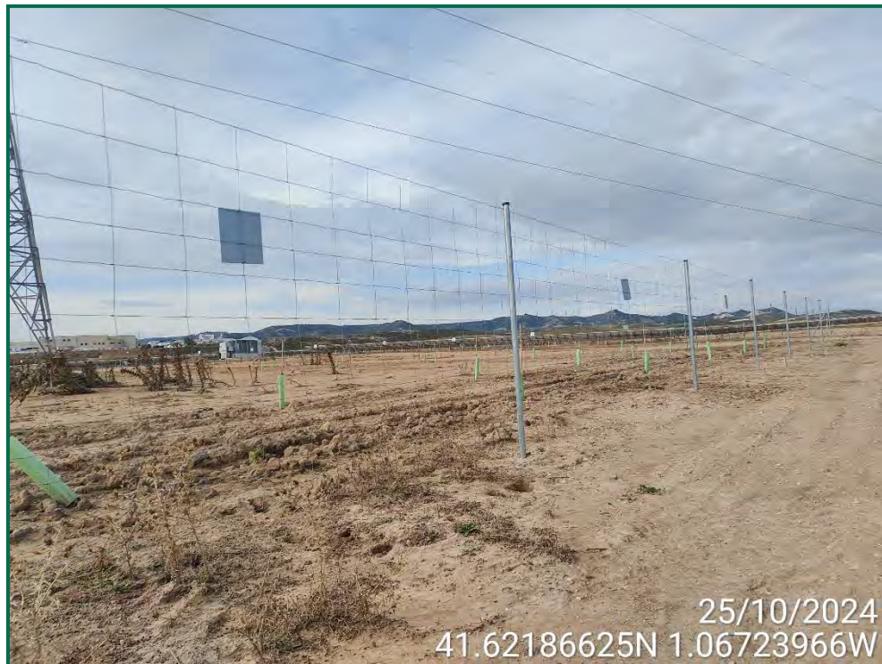
Fotografía 23. Placas anticollisión y vallado perimetral.
