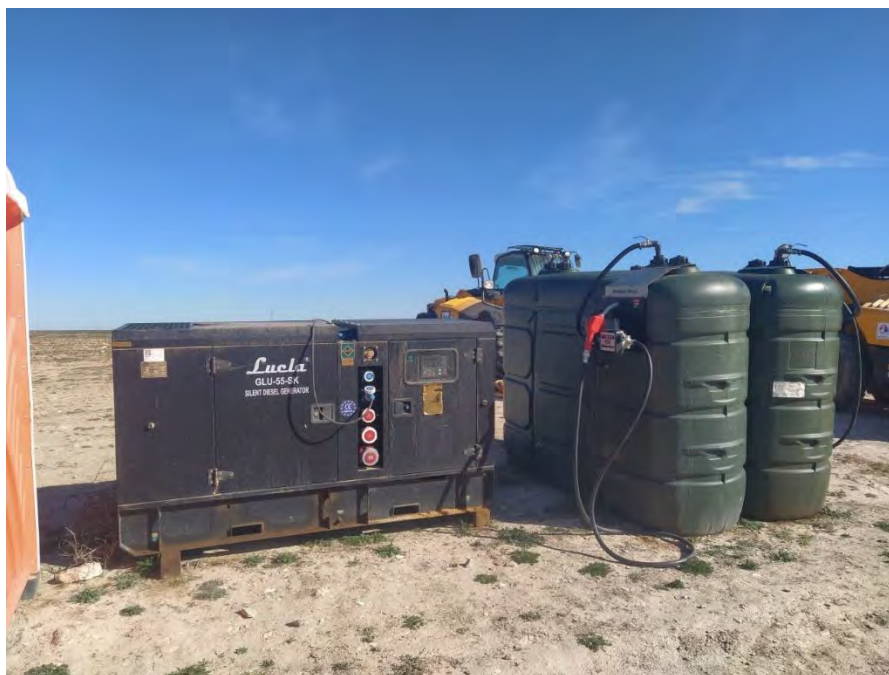
Fotografía 9. Grupo electrógeno, bidones de gasoil.
