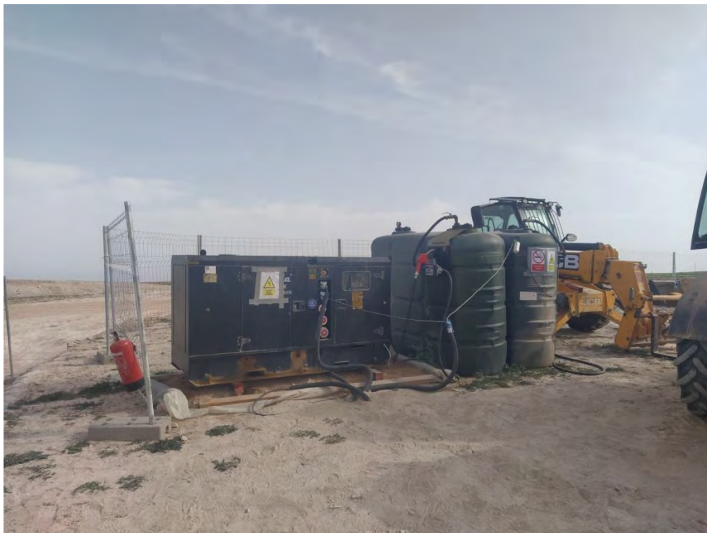
Fotografía 17. Grupo electrógeno y bidones de gasoil.
