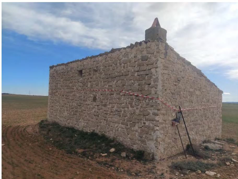
Fotografía 13. Caseta con balizado provisional (Caseta El Bochar)
