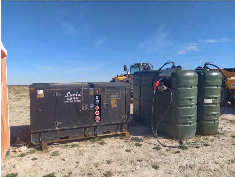
Fotografía 9. Grupo electrógeno, bidones de gasoil.
