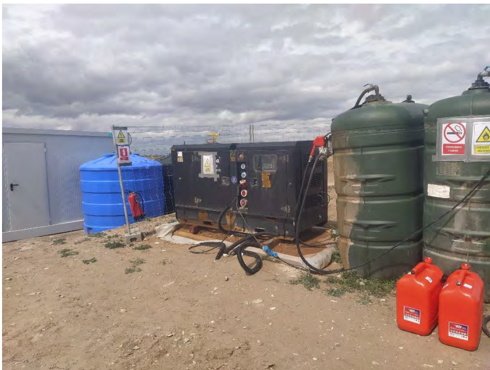
Fotografía 4. Grupo electrógeno y bidones de gasoil.
