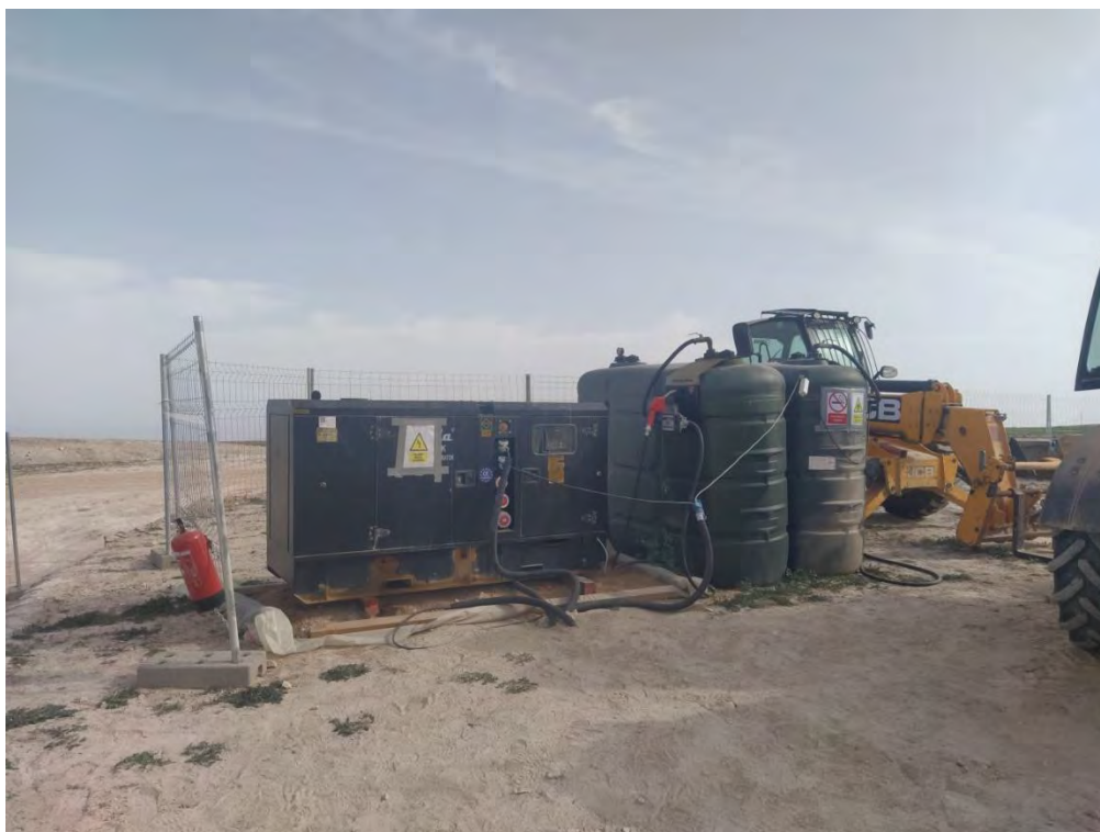
Fotografía 17. Grupo electrógeno y bidones de gasoil.
