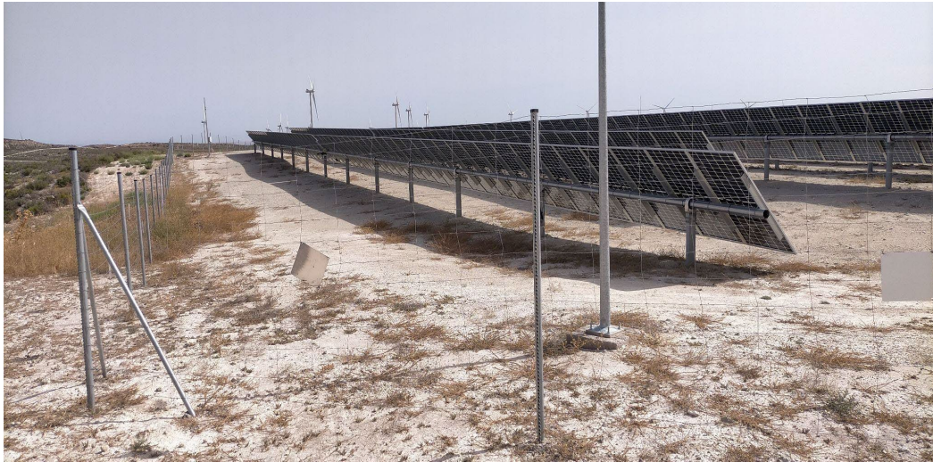
Fotografía 2. Placa anticollisión a punto de desprenderse en el lado sur de Cartujos 1 Parcela 3.
