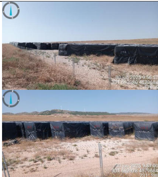
Estado de las lonas protectoras de los paneles solares, de la zona de almacén de materiales y zona de almacenamiento de herramientas.
