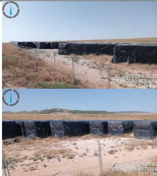
Estado de las lonas protectoras de los paneles solares, de la zona de almacén de materiales y zona de almacenamiento de herramientas.
