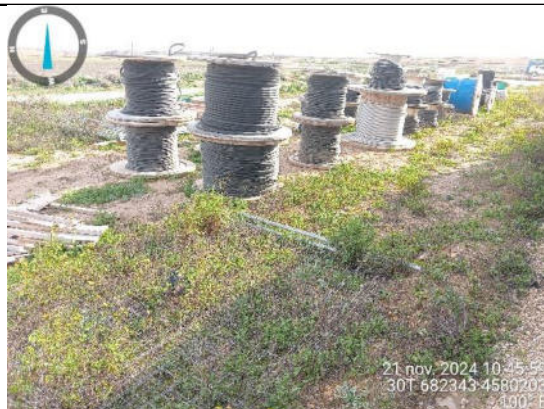
Estado de las lonas protectoras de los paneles solares y de la zona de almacén de materiales.
