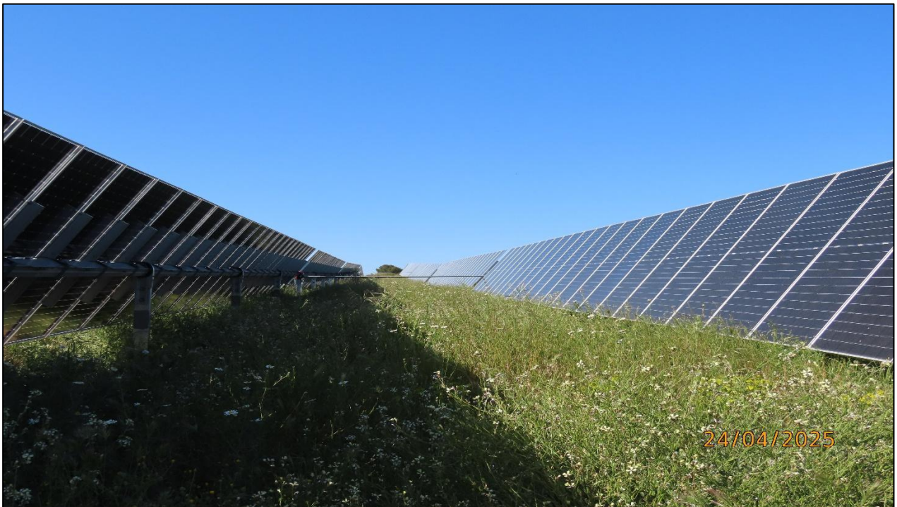
Ilustración 3. Cobertura vegetal en las calles entre paneles fotovoltaicos.
