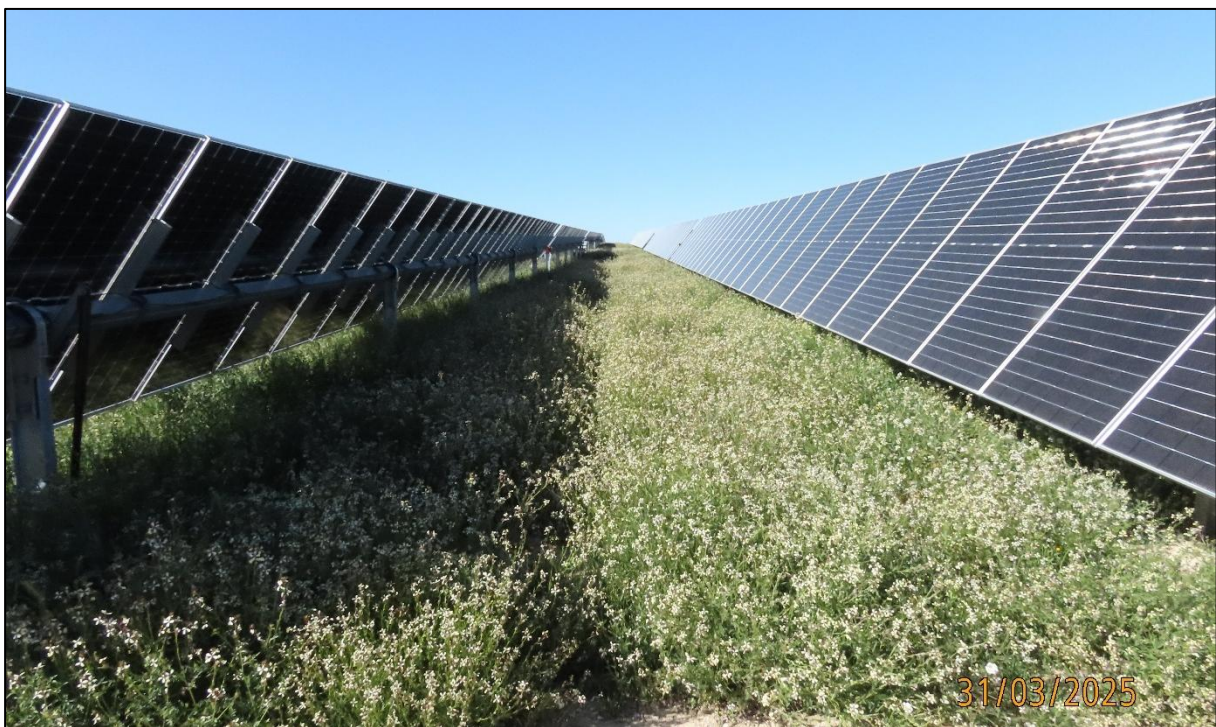
Ilustración 3. Cobertura vegetal en las calles entre paneles fotovoltaicos.
