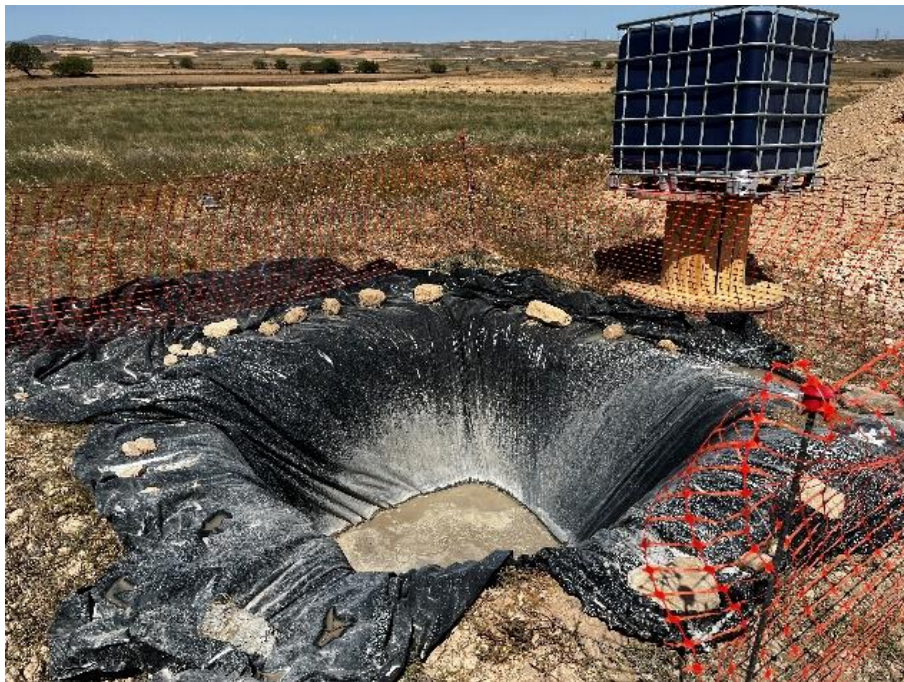
Figura 28 Zona de limpieza de cubas
