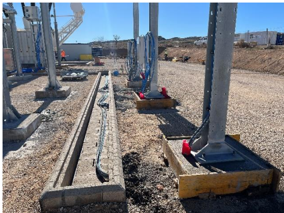
Figura 14 Cableado de la SET
