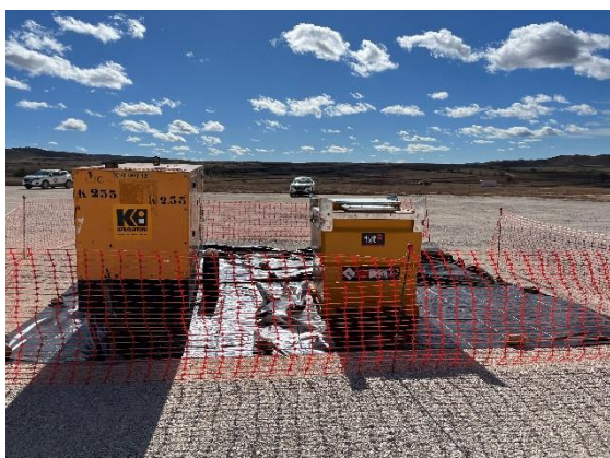
Figura 28 Grupo electrógeno impermeabilizado
