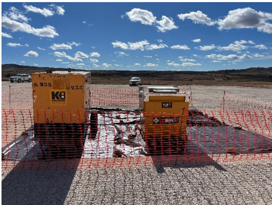
Figura 25 Grupo electrógeno sobre suelo impermeabilizado
