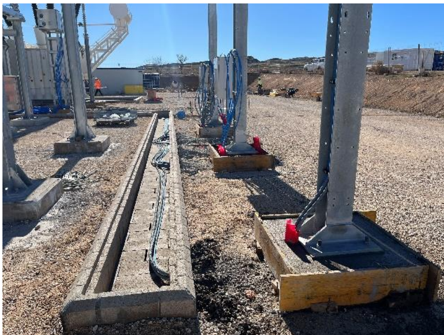
Figura 13 Cableado de la SET
