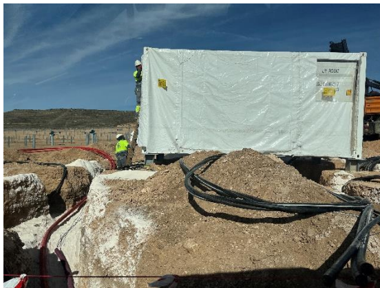
Figura 15 Cableado del CT
