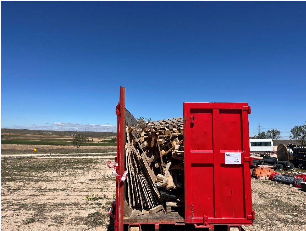
Figura 5 Contenedor para la madera de la SET 16/04/24
