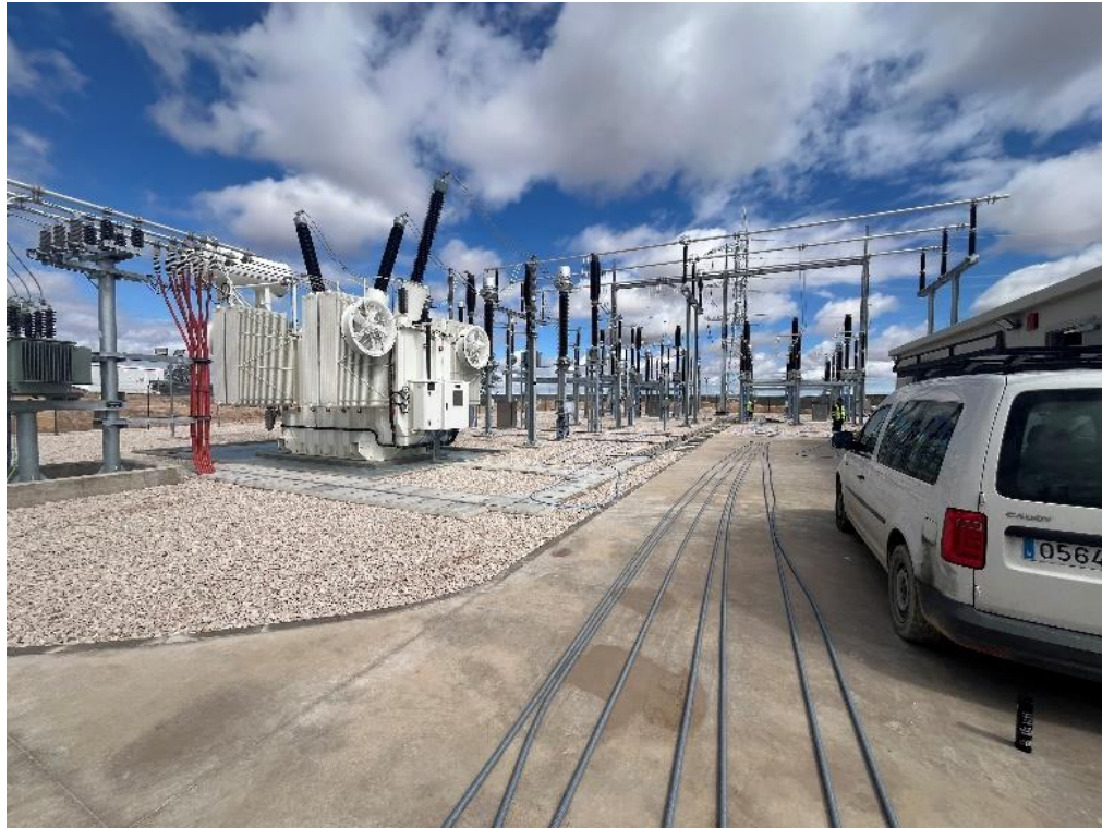
Figura 3 Cableado de la SET 14/05/24
