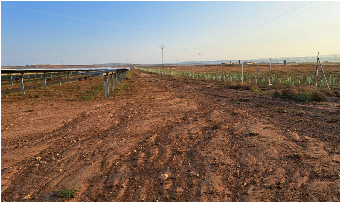
Foto 14. Aparición de procesos erosivos (regueros) en el interior de la planta tras unas fuertes lluvias. Agosto 202
