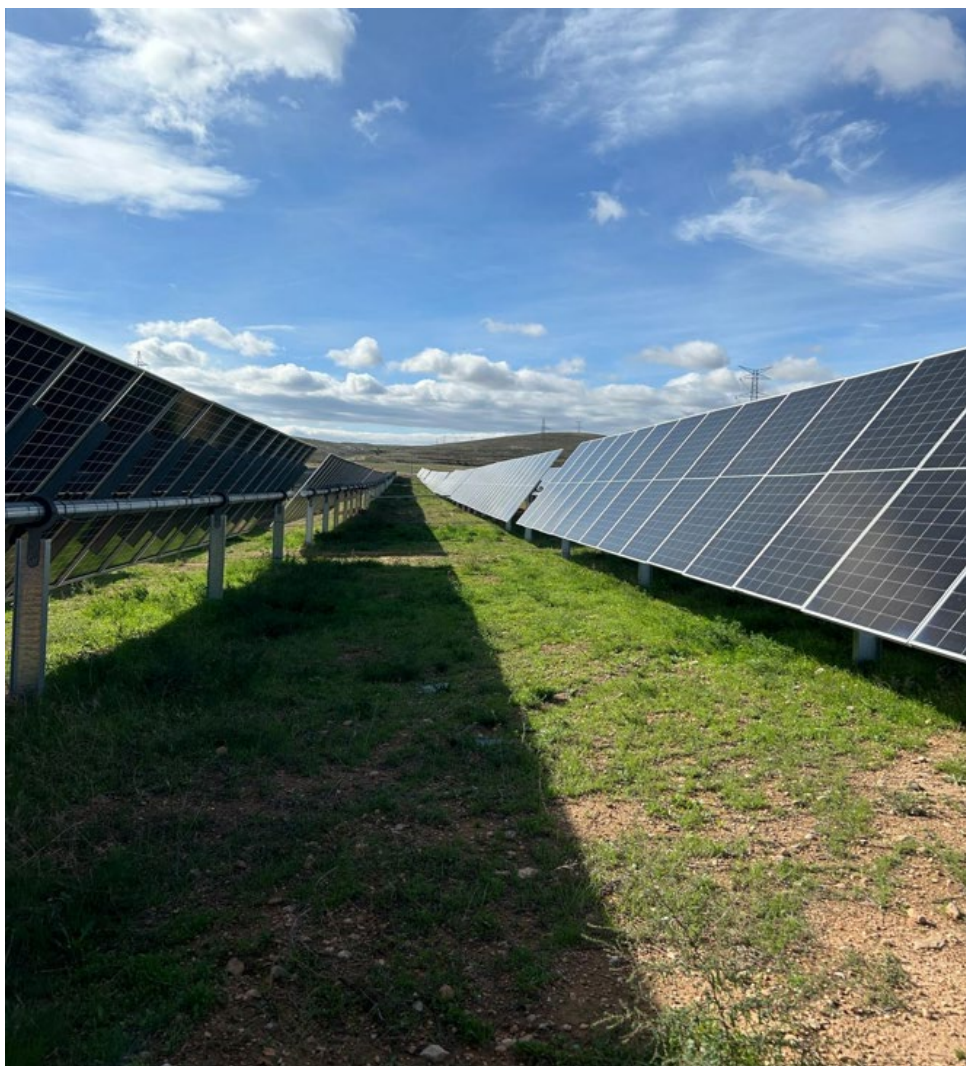
Foto 6. Cubierta vegetal bajo los seguidores. Septiembre 2024.
