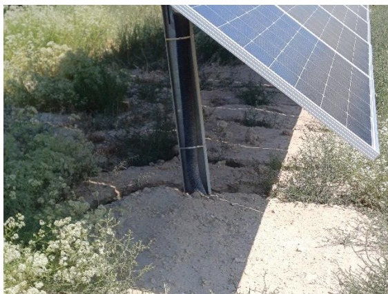
Imagen 3. Cárcava que discurre junto a una hinca
