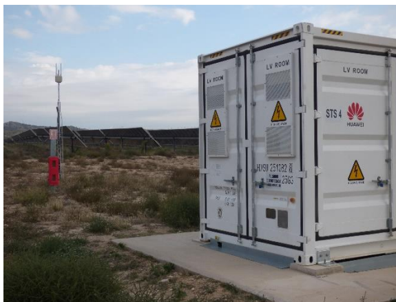
Imagen 20. Extintor junto a uno de los centros de transformación con los que cuenta la planta fotovoltaica
