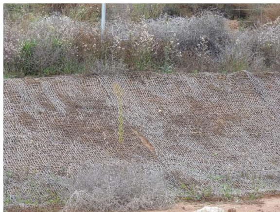
Imagen 22. Estado del talud de la zanja Norte – Sur, en la cabeza del mismo se desarrolla una cobertura de vegetación natural, mientras que en el resto no hay vegetación
