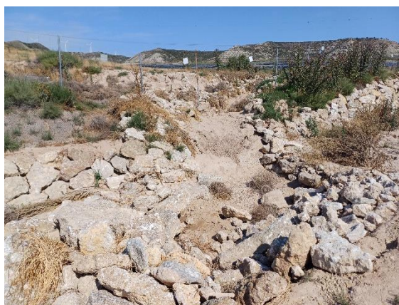
Imagen 6. Daños provocados en la zanja de drenaje como consecuencia de las lluvias torrenciales registradas en la zona
