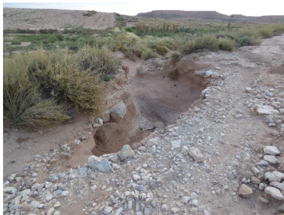
Imagen 4. Cárcava situada fuera del vallado perimetral de la planta fotovoltaica generada por las lluvias torrenciales registradas en la zona
