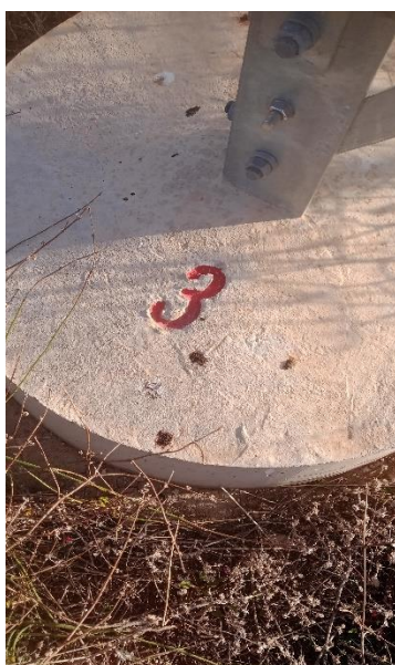
Imagen 1. Excrementos de ave en el apoyo nº3 de la LAAT
