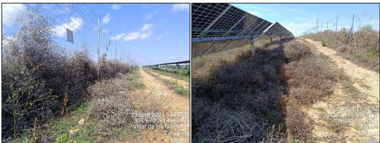
Figura 31: Vegetación rodada acumulada contra el vallado de la PSFV y entre las filas de módulos solares.
