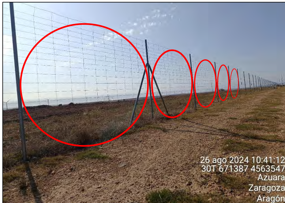
Figura 11: Tramo de vallado de la cara este de la PSFV en el que faltan numerosos paneles anticollisión.
