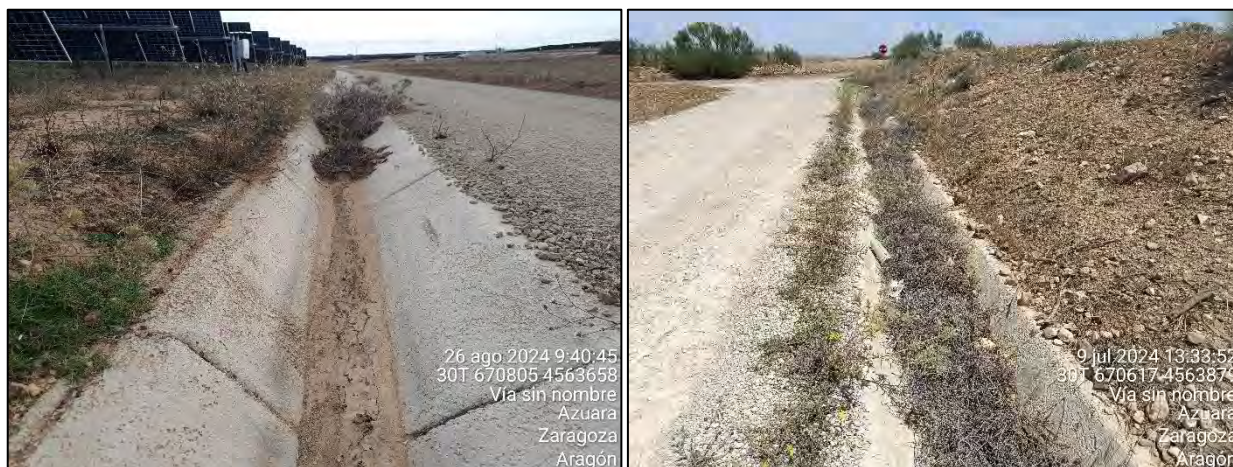
Figura 25: Canal de drenaje con acumulación de sedimentos y vegetación.
