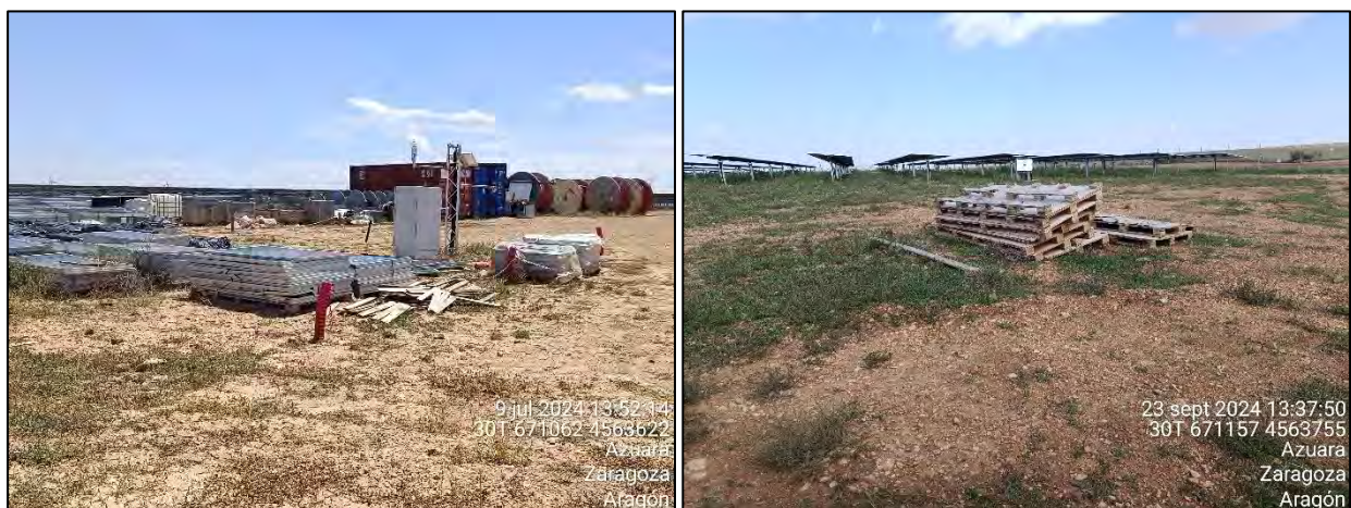
Figura 23: Pales, módulos solares y otros materiales acopiados dentro del perímetro de la PSFV.
