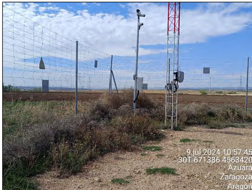
Figura 30: Vegetación rodada acumulada contra el vallado de la PSFV en el interior del recinto, en la esquina sureste.
