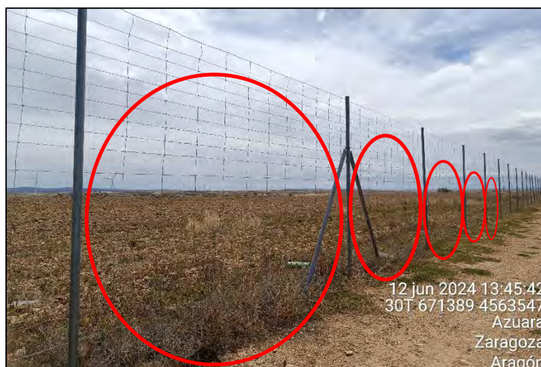
Figura 13: Tramo de vallado de la cara este de la PSFV en el que faltan numerosos paneles anticolidión.
