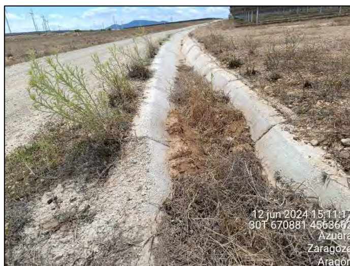
Figura 26: Canal de drenaje con acumulación de sedimentos y vegetación.
