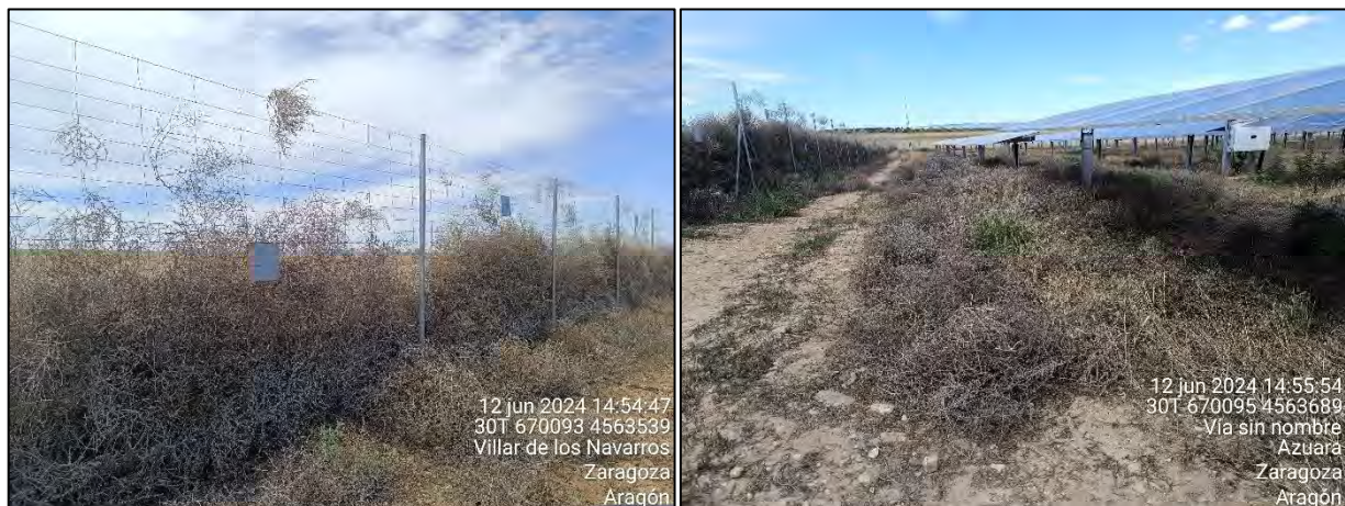
Figura 30: Vegetación rodada acumulada contra el vallado de la PSFV y entre las filas de módulos solares.
