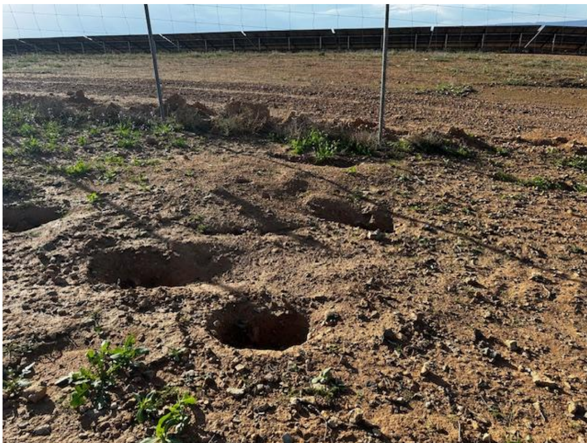
Imagen 4. Cados localizados en el recinto de la planta fotovoltaica.
