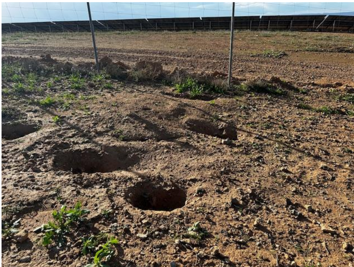
Imagen 6. Cados localizados en el recinto de la planta fotovoltaica.
