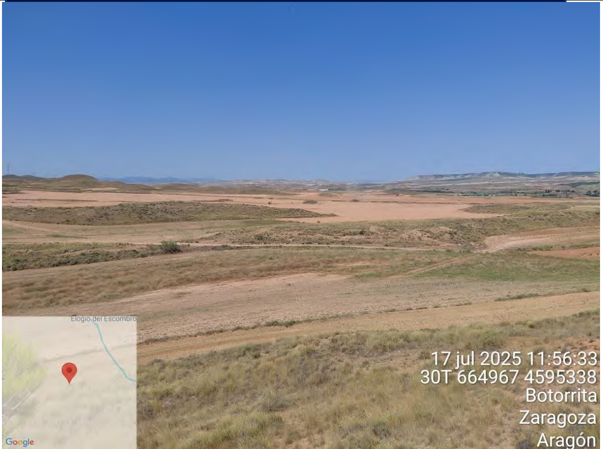
F4: Estado de las obras en la Planta Solar Fotovoltaica Taburete Solar I.
