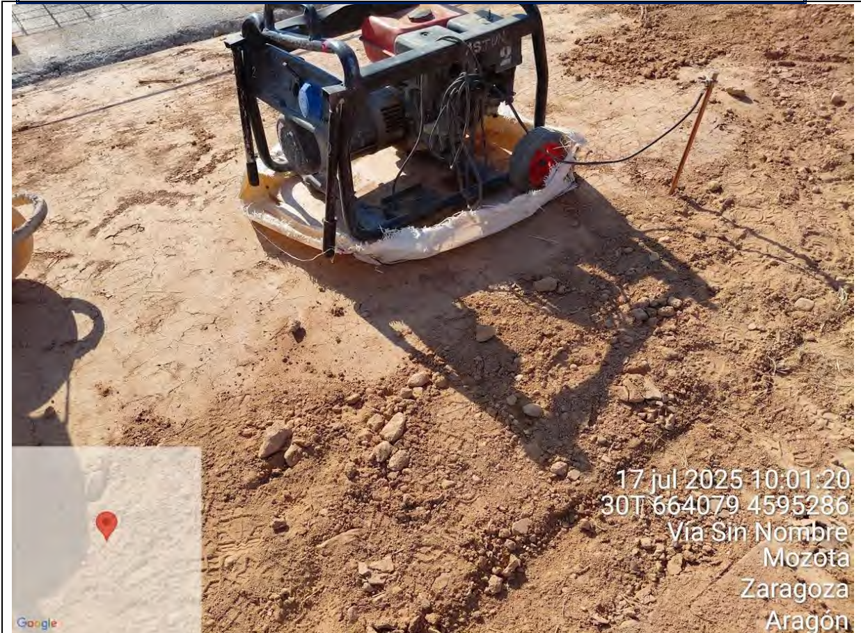
F19: Grupo electrógeno sin bandeja antiderrame
