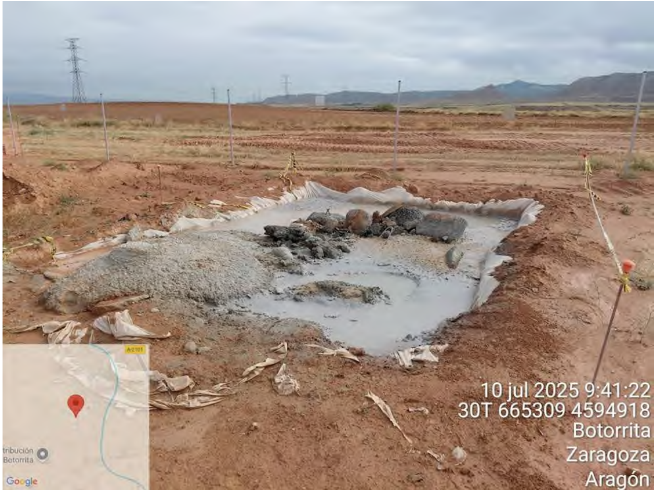
Imagen 18. Balsa de lavado de canaletas, en PSFV Taburete.
