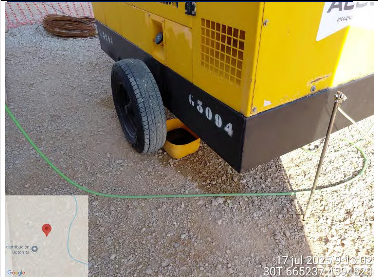
F10: Derrame de aceite en un grupo electrógeno
