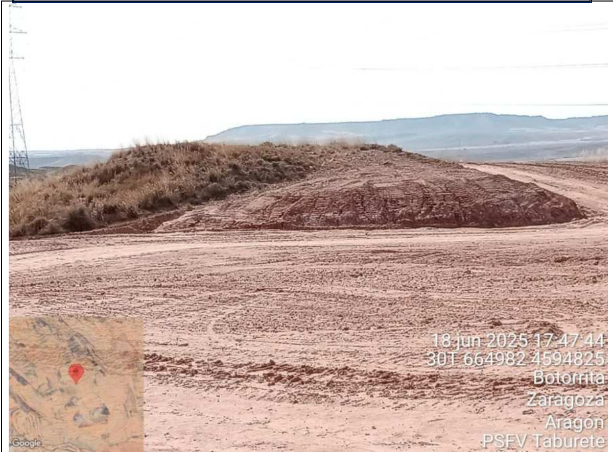
F24: Ribazo dañado, en la Planta Fotovoltaica Taburete.
