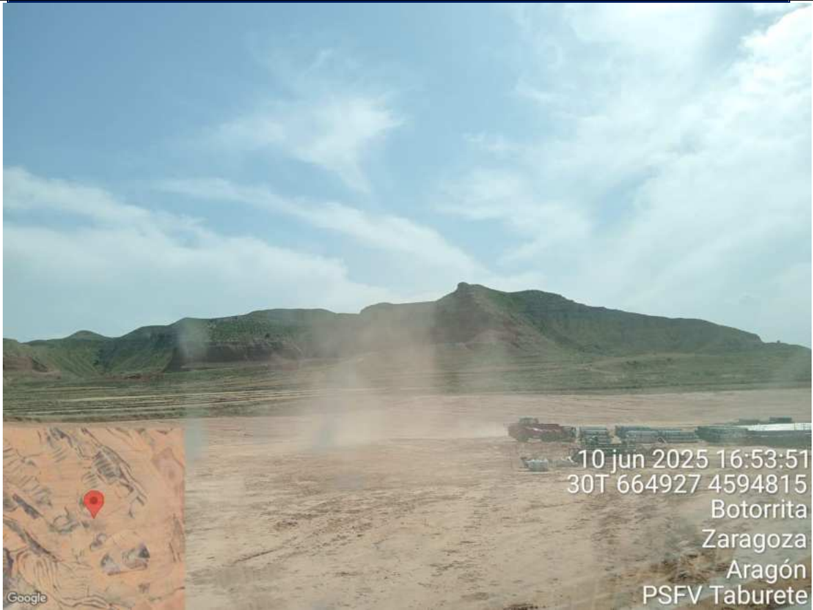
F24: Grandes nubes de polvo, en la Planta Fotovoltaica Taburete.
