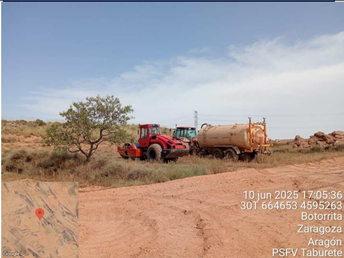
F26: Maquinaria estacionada en un área sin impermeabilizar, en la Planta Fotovoltaica Taburete.
