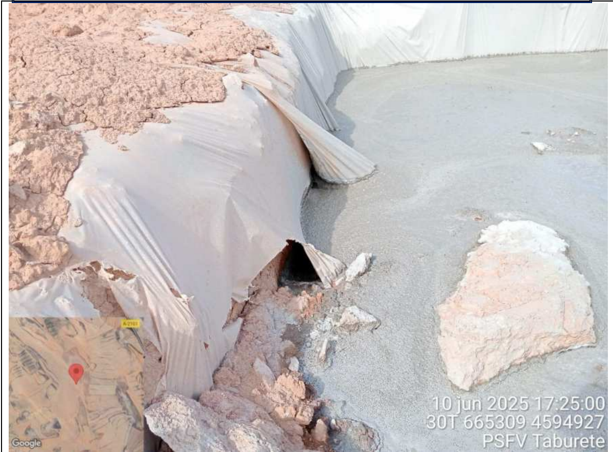
F6: Filtración en el suelo por rotura de la lámina geotextil, en la Subestación Taburete Solar.
