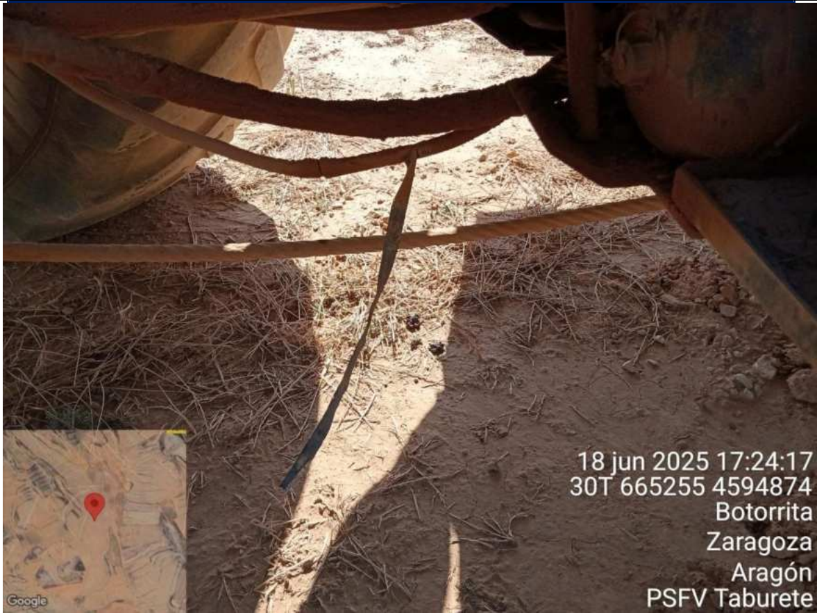
F7: Vertido de grasa y aceite, en la Subestación Taburete Solar.
