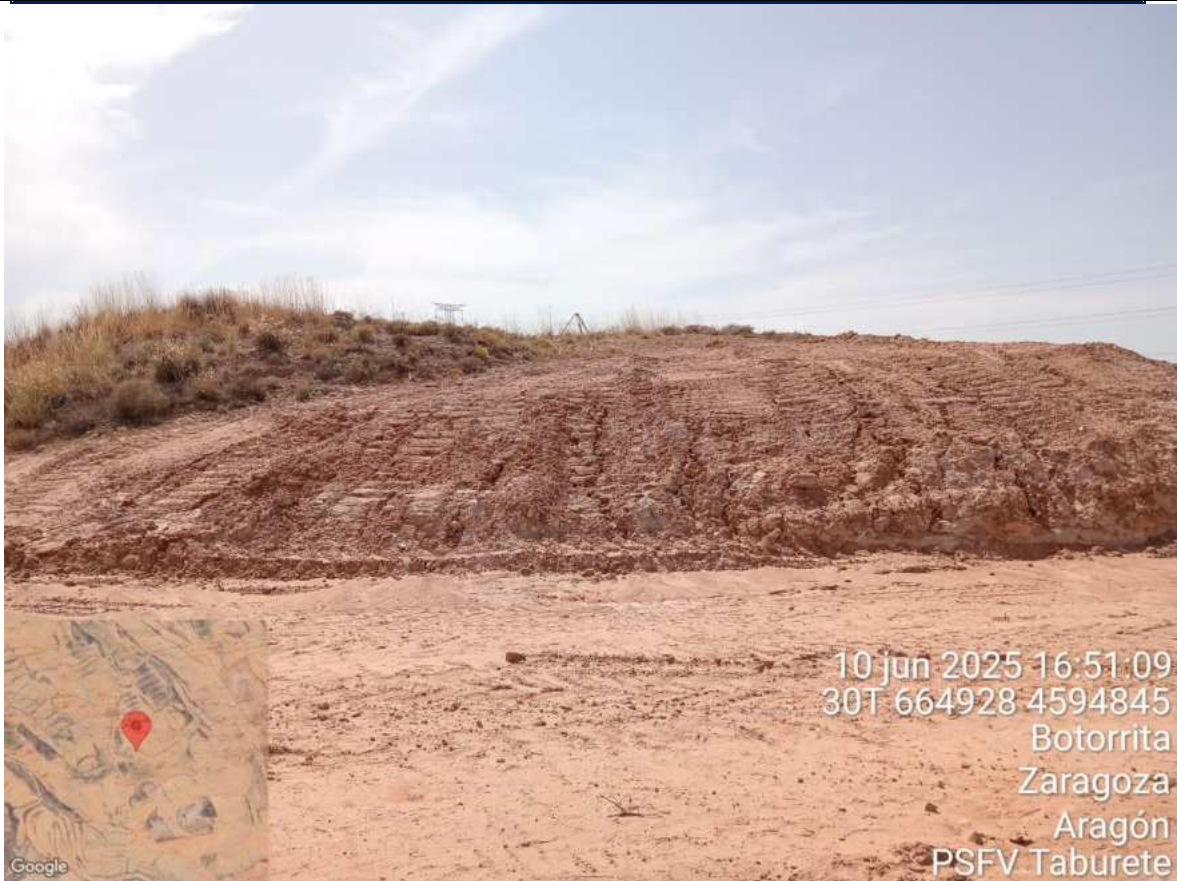
F18: Ribazo dañado por el paso de la maquinaria, en la Planta Fotovoltaica Taburete.
