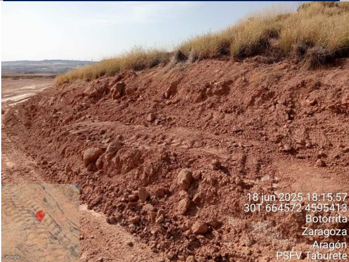
F19: Ribazos dañados, en la Planta Fotovoltaica Taburete Solar.
