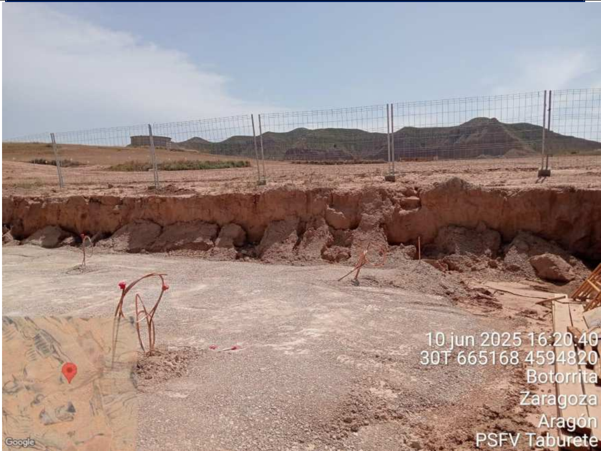
F11: Estado del talud Sur, Subestación Taburete Solar.
