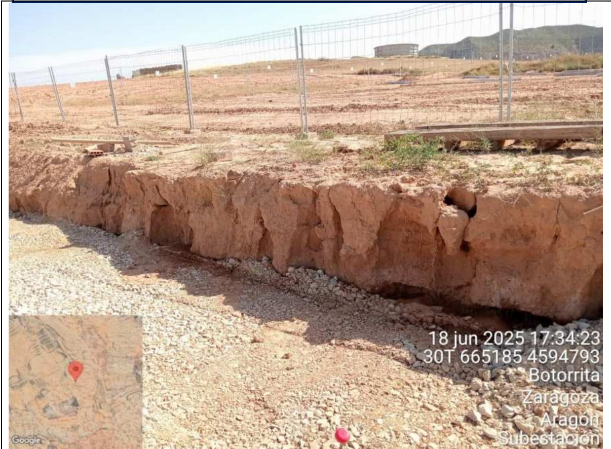
F14: Desprendimientos en talud, en Subestación Taburete Solar.
