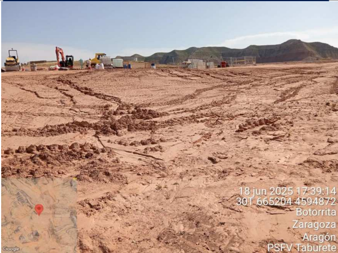
F26: Erosiones, en la Planta Fotovoltaica Taburete.
