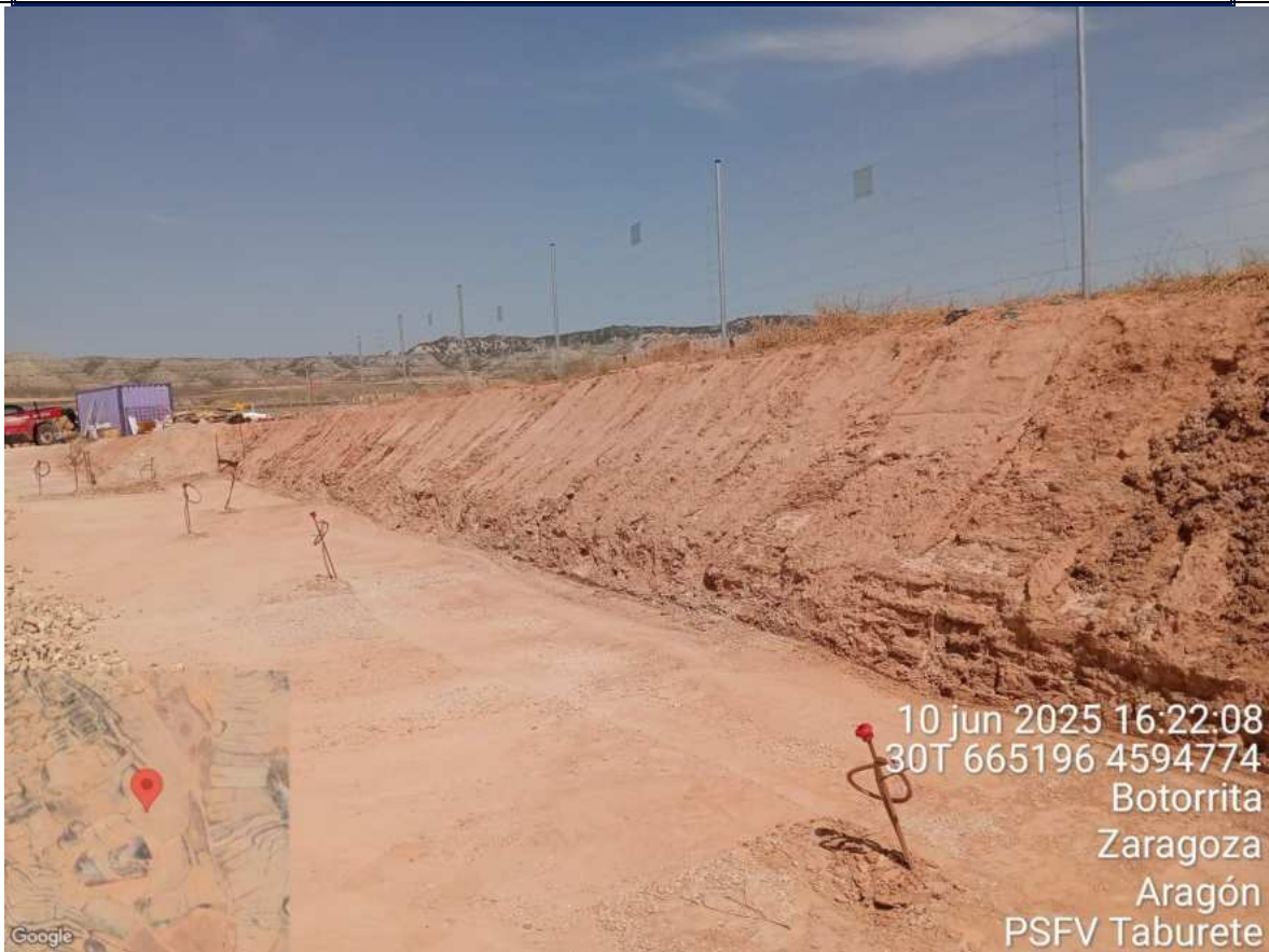
F10: Cárcavas en talud Este, Subestación Taburete Solar.
