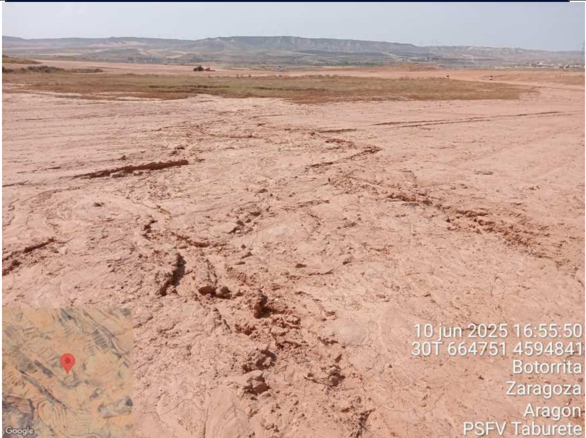
F21: Cárcavas, en la Planta Fotovoltaica Taburete.
