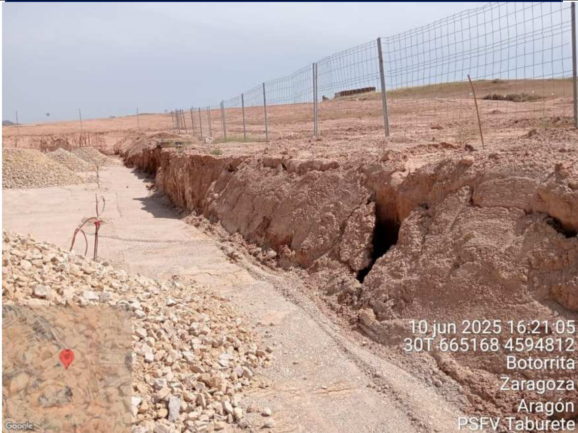
F9: Desprendimiento del talud Sur, en la Subestación Taburete Solar.
