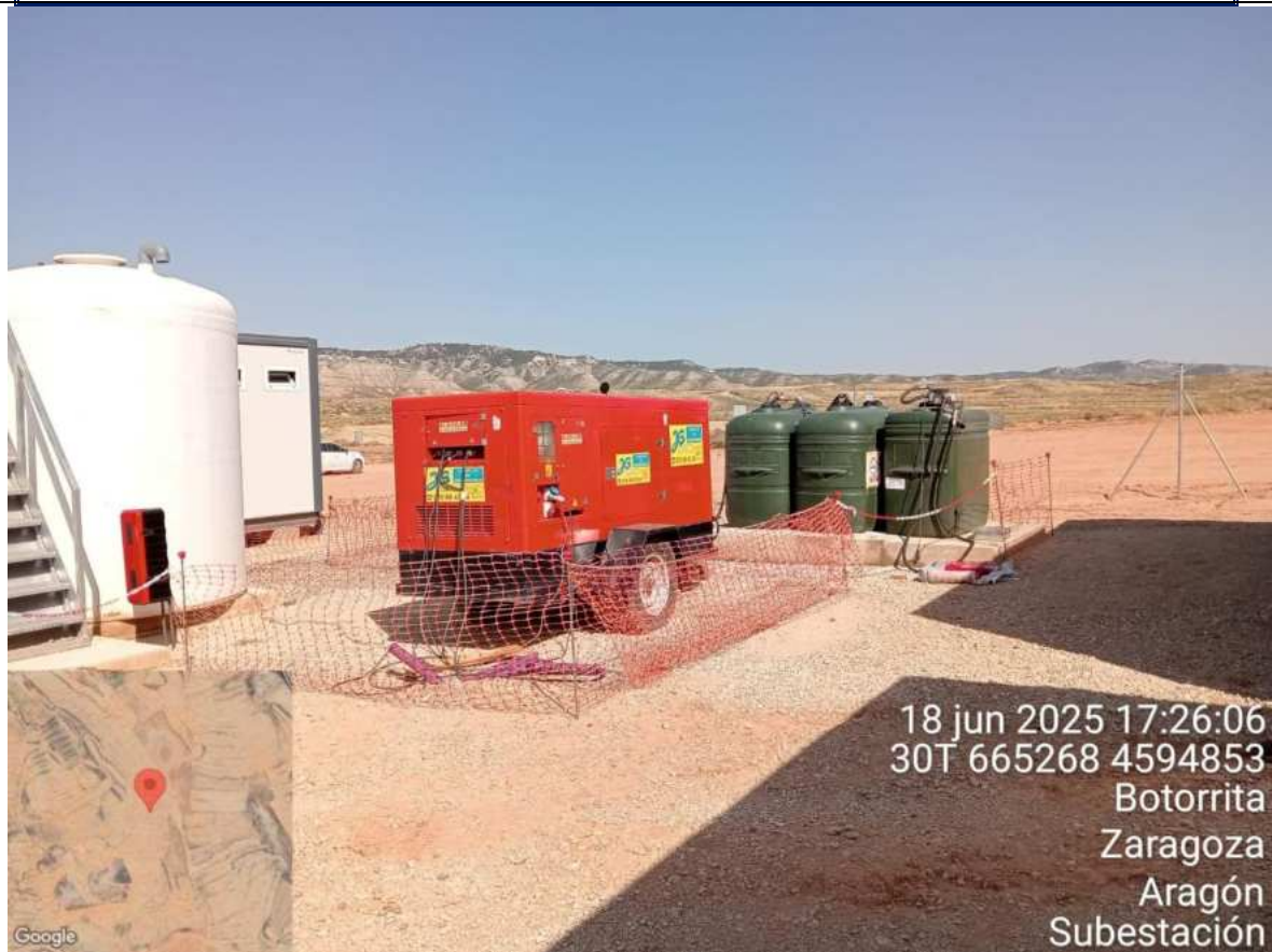
F8: Grupo electrógeno y depósitos de combustible sin aislar de la luz solar directa, en la Subestación Taburete Solar.
