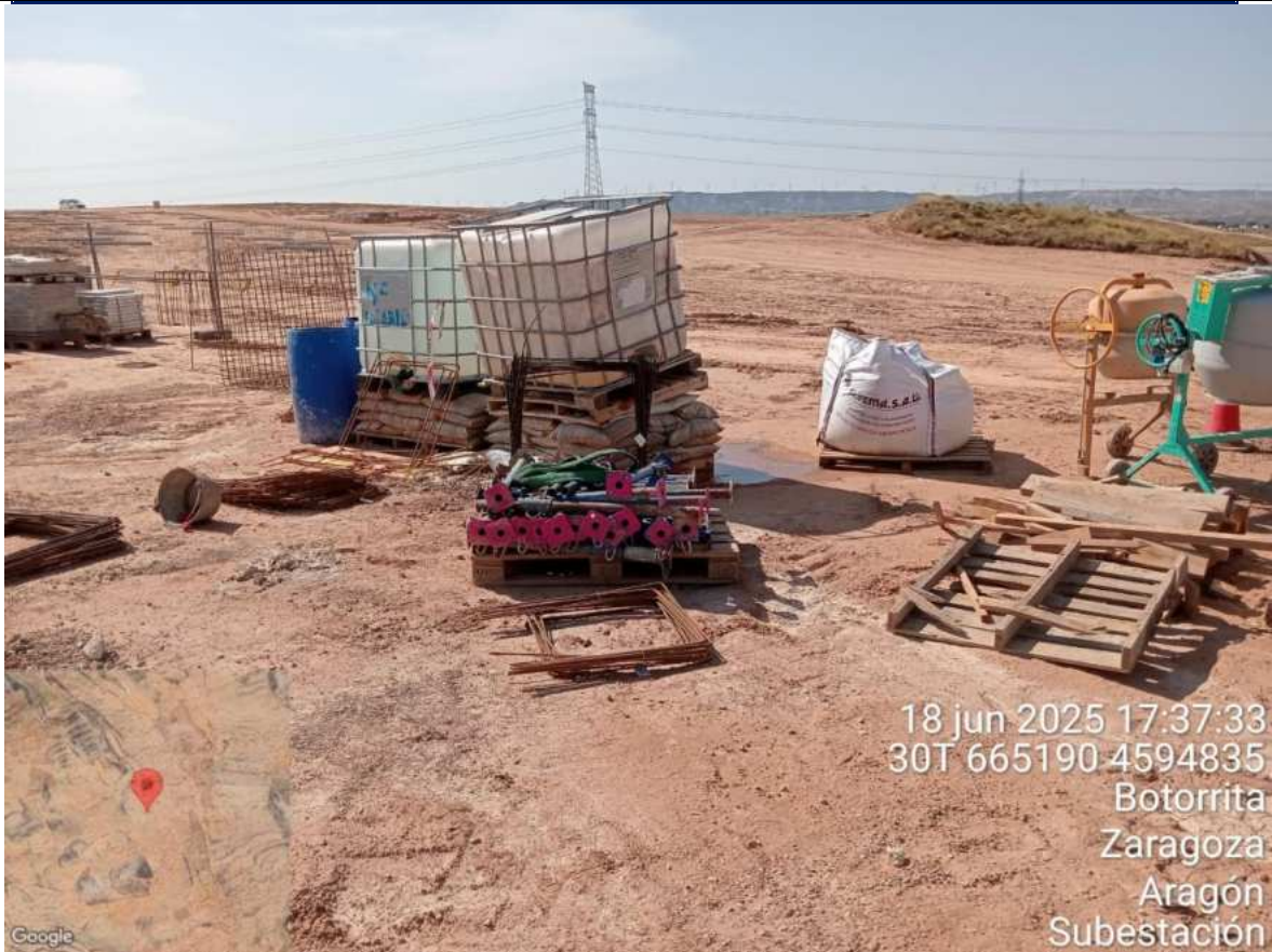
F15: Vertidos continuos por limpieza de hormigonera, junto a Subestación.
