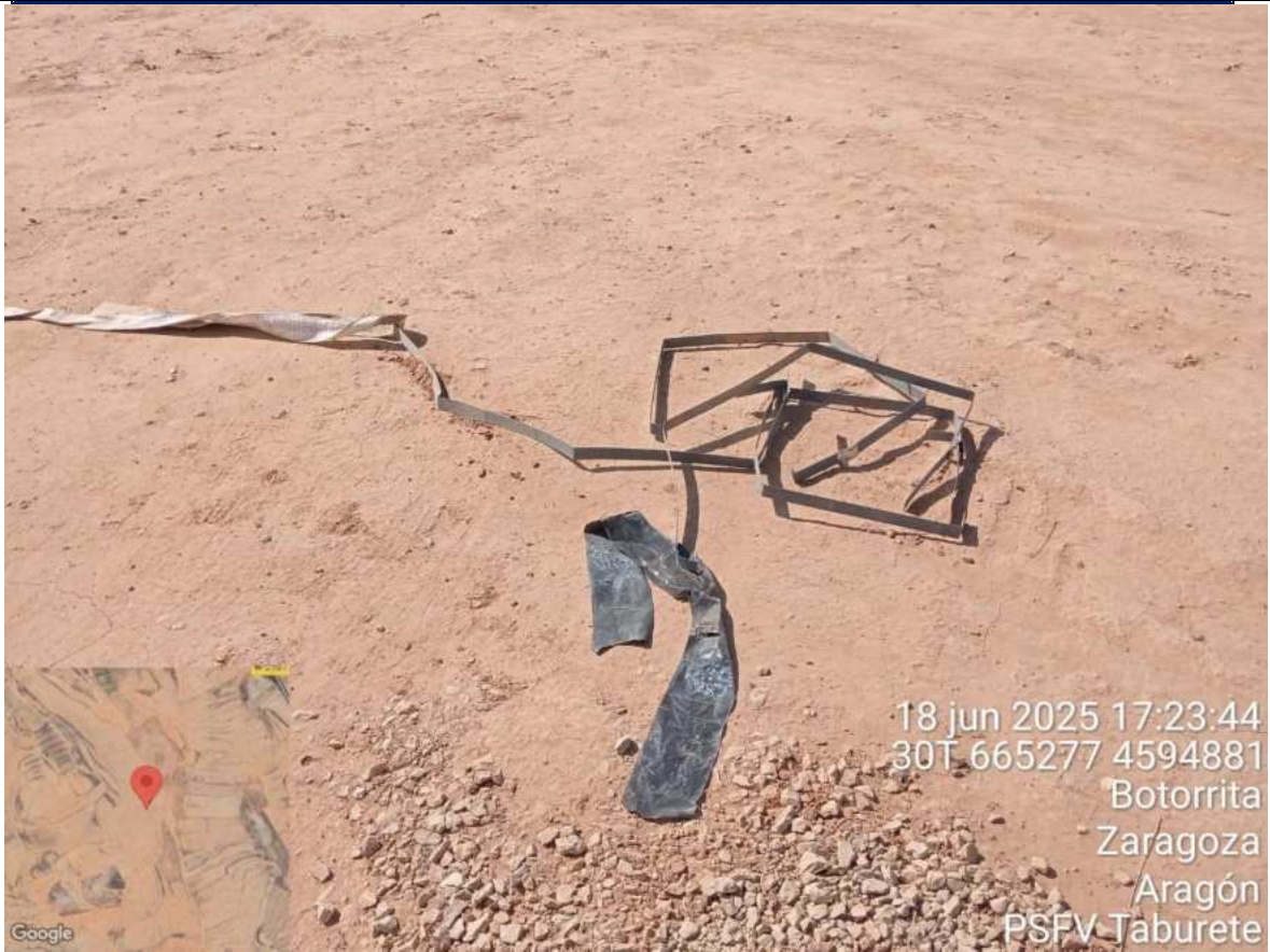
F9: Flejes y plásticos por diferentes zonas, en la Subestación Taburete Solar.
