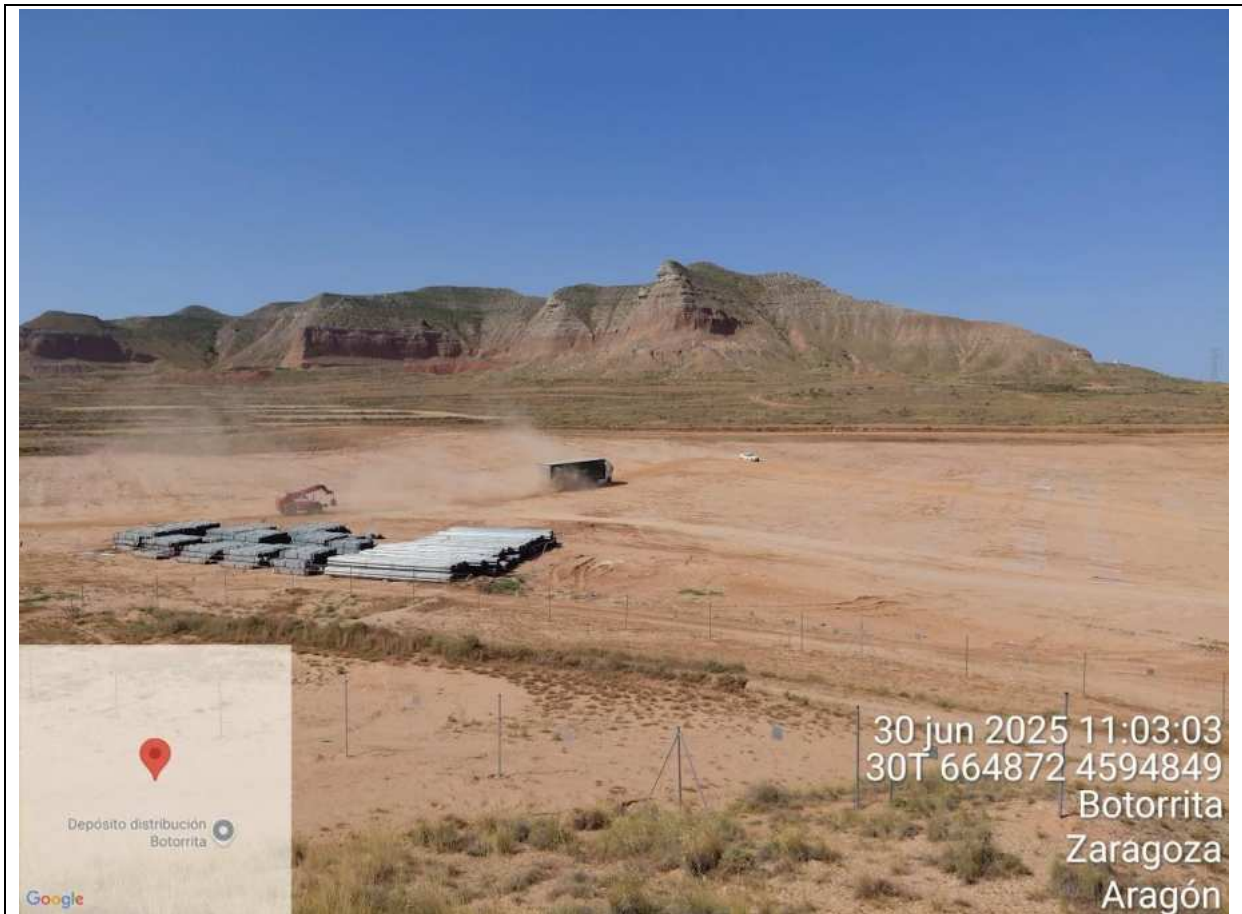
F13: Dispersión de polvo en áreas de trabajo por falta de riegos, en la Planta Fotovoltaica.
