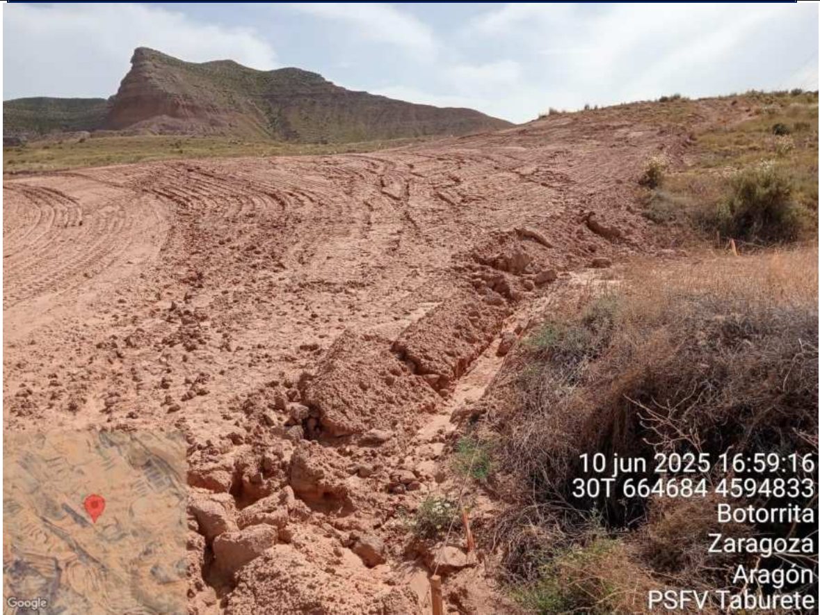
F22: Cárcavas, en la Planta Fotovoltaica Taburete.
