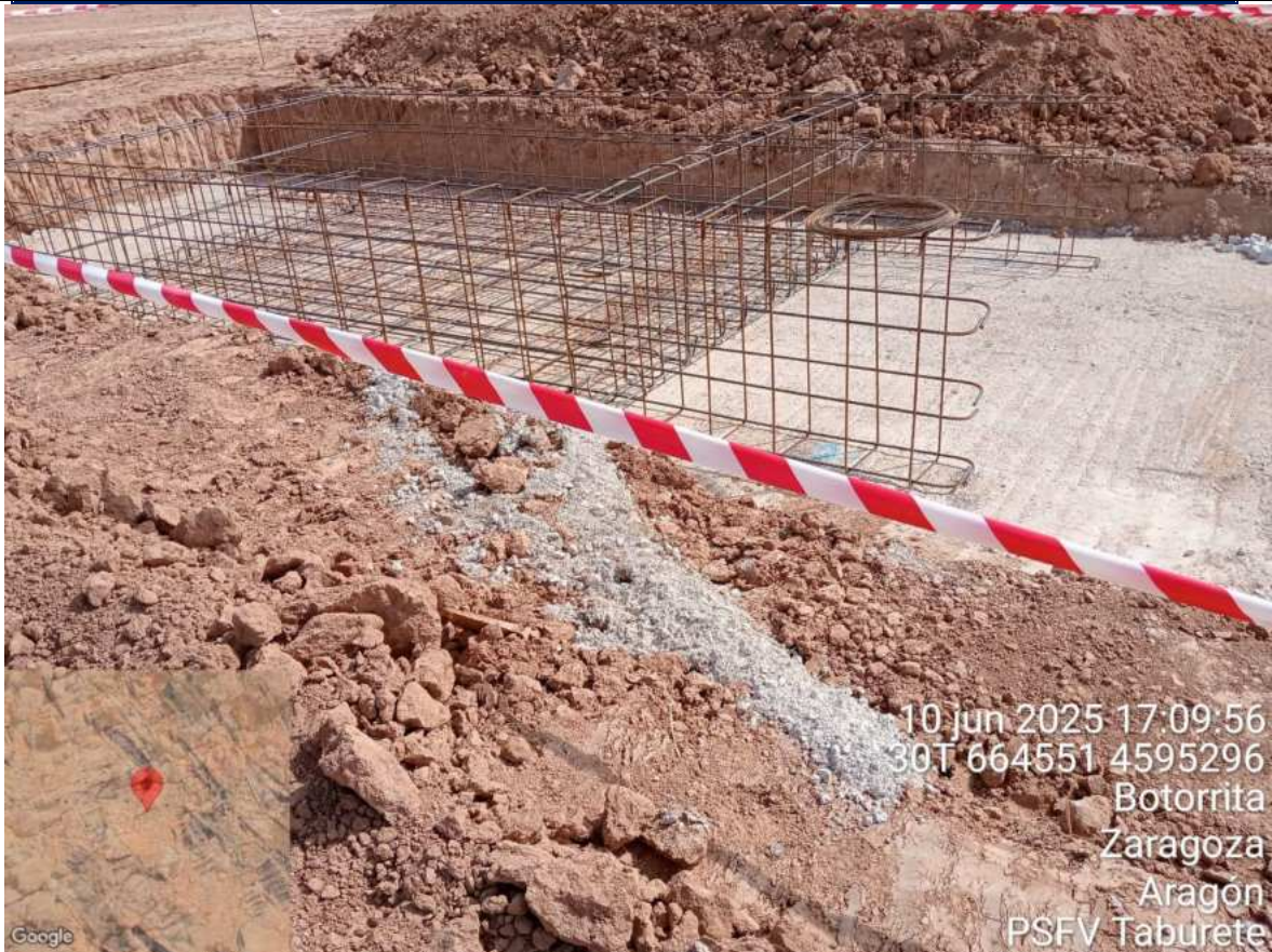
F25: Vertidos de hormigón en algunas cimentaciones de CT's, en la Planta Fotovoltaica Taburete.
