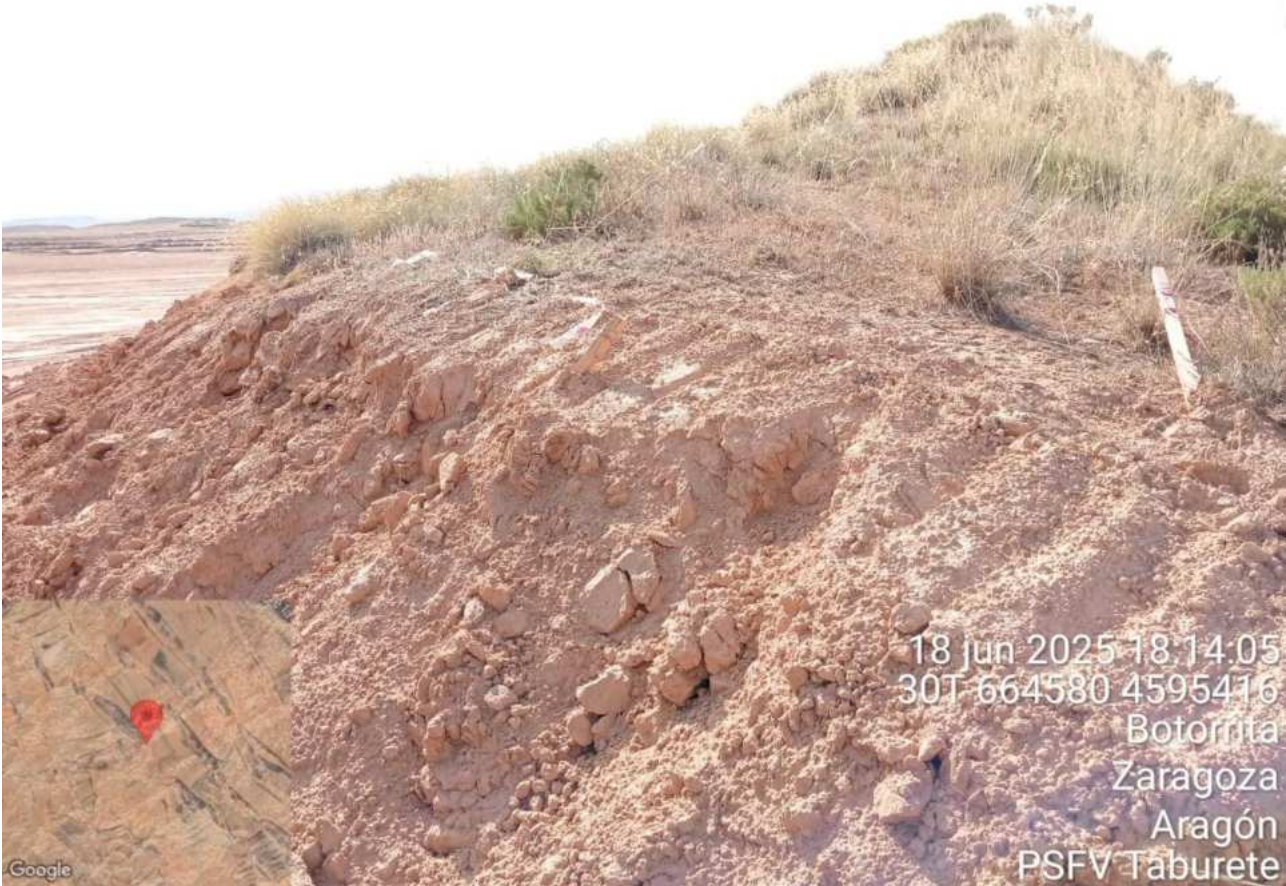
Imagen 11. Daño a ribazo por el tránsito de maquinaria, en el interior de las instalaciones.
