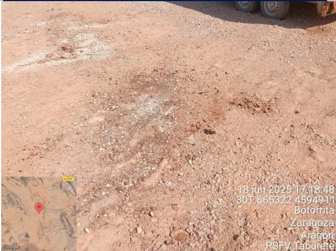
F11: Vertidos de hormigón por limpieza de hormigonera, Subestación Taburete Solar.
