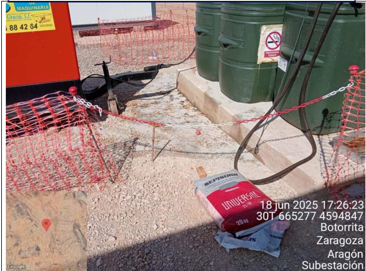
F6: Vertido de combustible, en la Subestación Taburete Solar.
