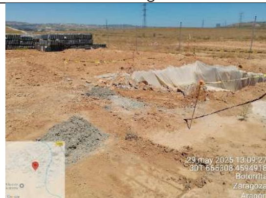
F9: Derrames de hormigón junto a la balsa para el lavado de las hormigoneras
