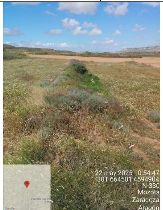
F8: Estado del balizamiento (nº 34)
