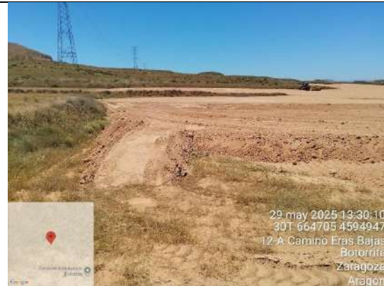
F7: Estado actual de un acopio de tierra vegetal
