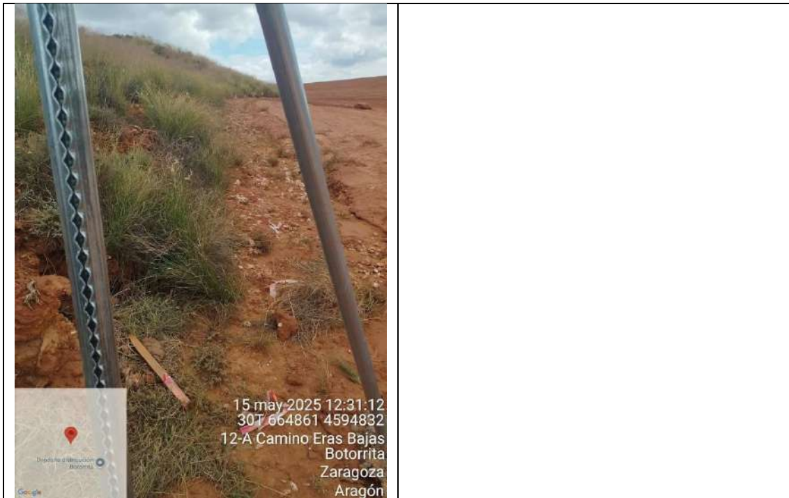
F11: Balizamiento en mal estado en el ribazo nº 39
