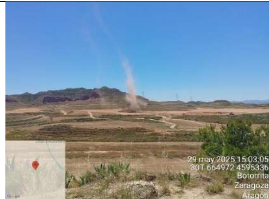
F8: Emisiones de polvo durante los movimientos de tierras
