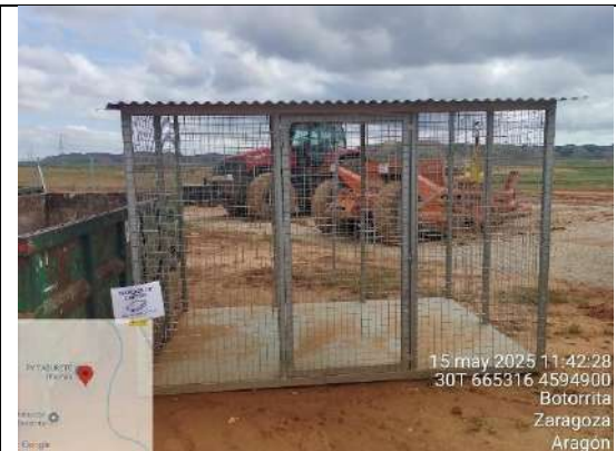
F14: Jaulón destinado para el almacenamiento de los residuos peligrosos
