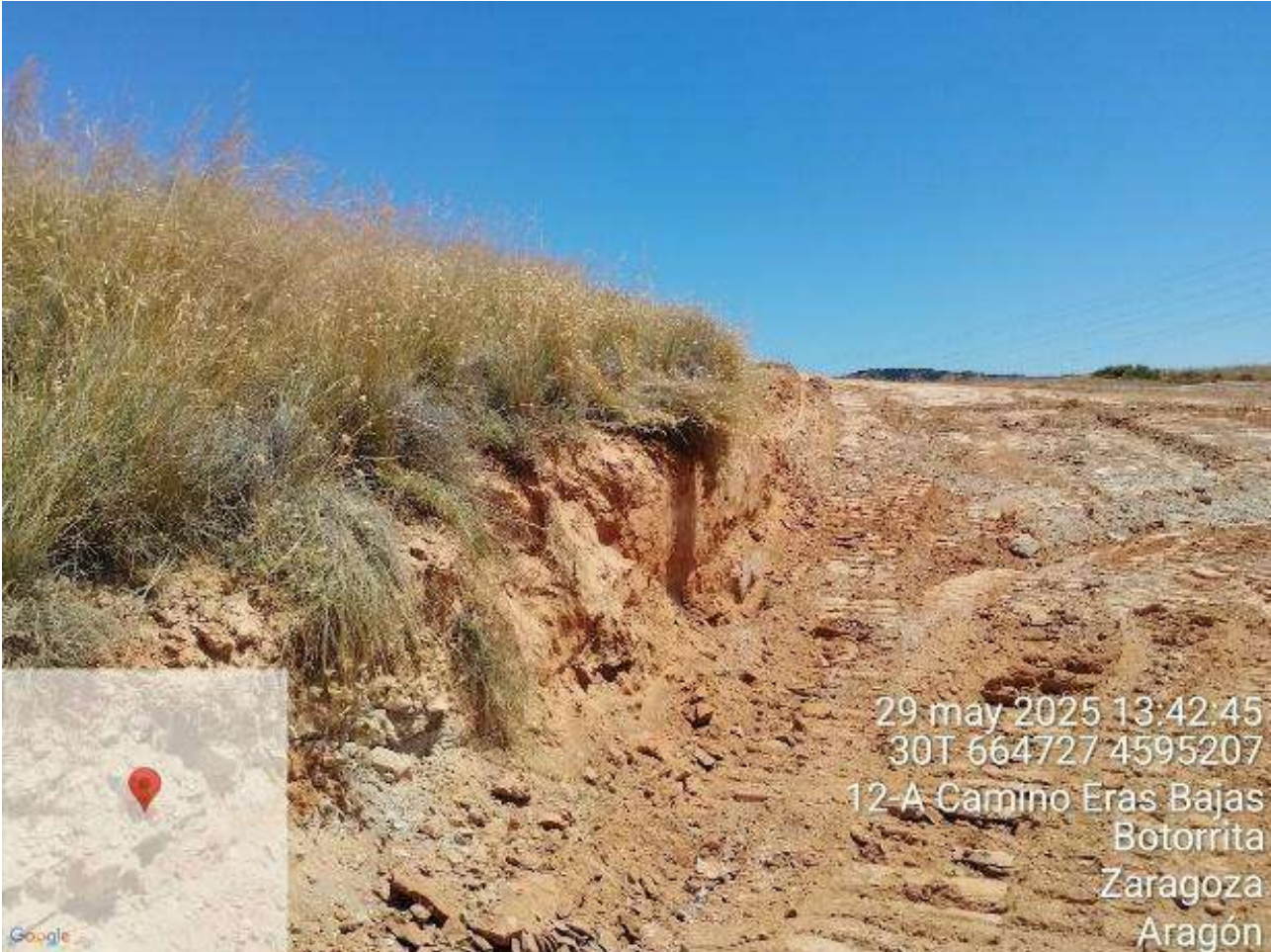
Imagen 11. Daño a ribazo por el tránsito de maquinaria, en el interior de las instalaciones.
