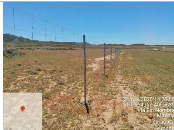
F3: Malla instalada en el vallado perimetral de la zona occidental
