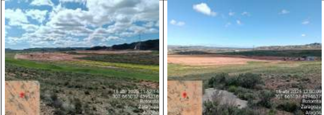
F5: Trabajos de movimiento de tierras F6: Trabajos de movimiento de tierras
