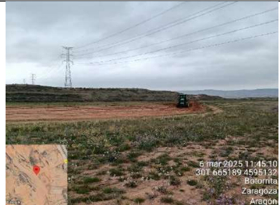
F4: Acopio incorrecto de tierra y maquinaria pasando por encima
