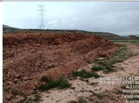
F5: Acopio de tierra vegetal superior a 1,5 metros
