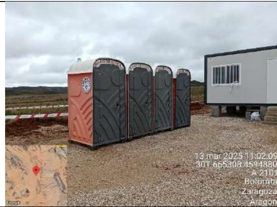
F7: Instalación baños químicos provisionales
