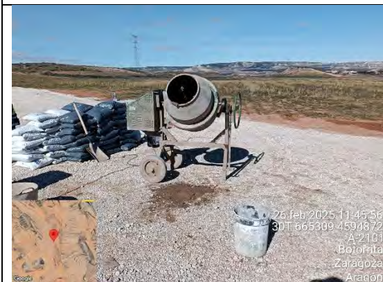
F11: Hormigonera sin balsa de lavado
