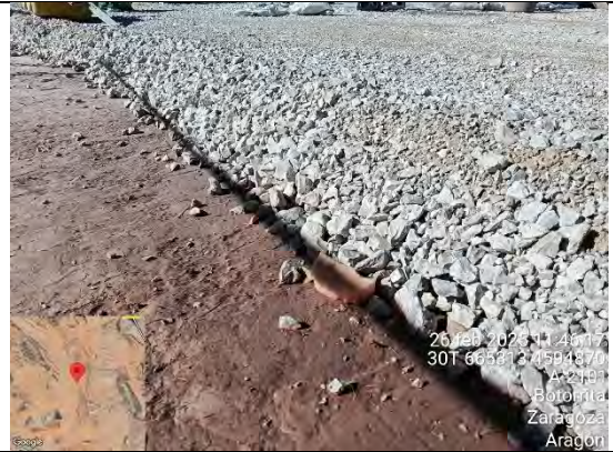
F8: Residuos detectados en la obra
