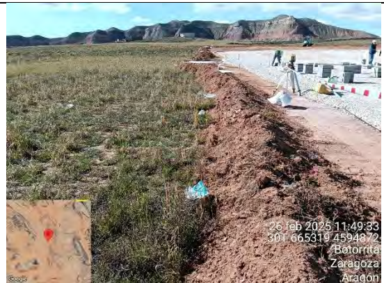
F10: Residuos detectados en la obra
