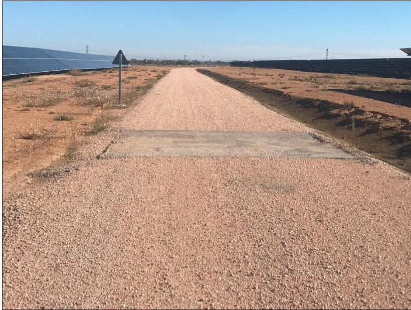
Foto 17: Aspecto de uno de los drenajes perpendiculares a un camino interior de la PSFV SEDEIS V.
