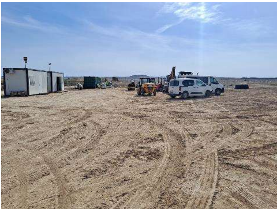
Figura 8.7. Instalaciones y parking de vehículos y maquinaria entre las plantas “San Pedro” y “Épila”
