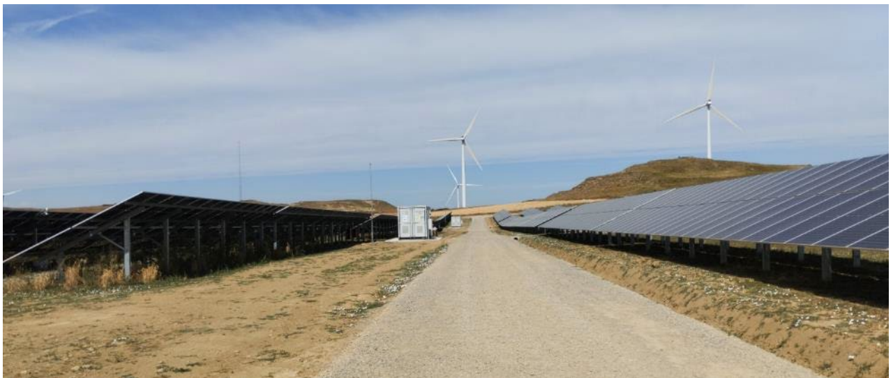
Aspecto general de la PSFVH Rabosera, plenamente instalada
