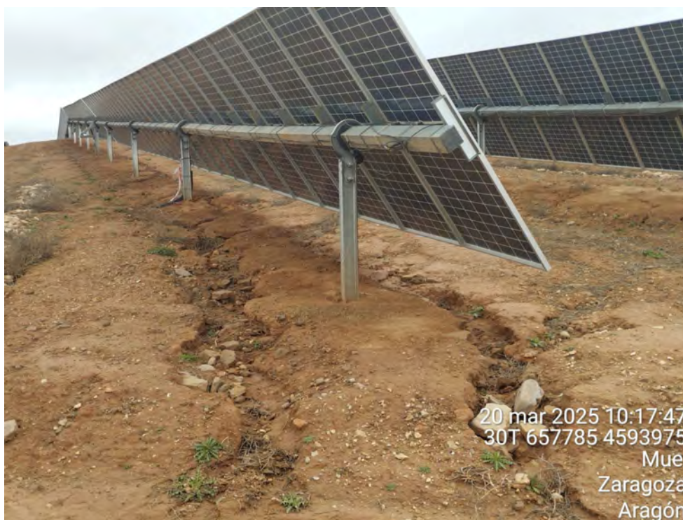
Fotografía 8. Nuevos signos de erosión y cárcavas
