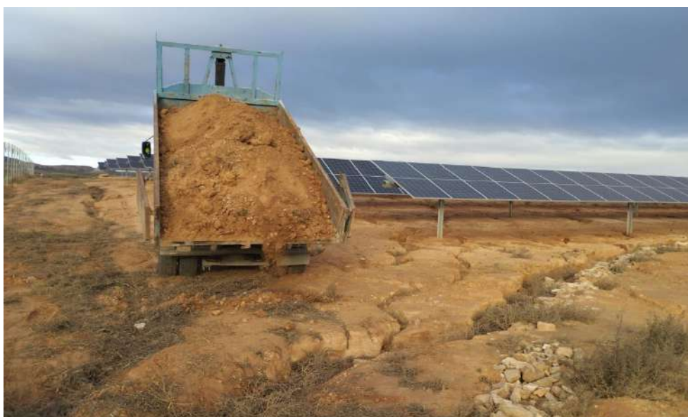
Fotografía 10. Relleno cárcavas y signos de erosión
