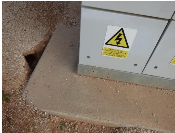
Imagen 14. Boca de madriguera junto a la losa de un centro de transformación
