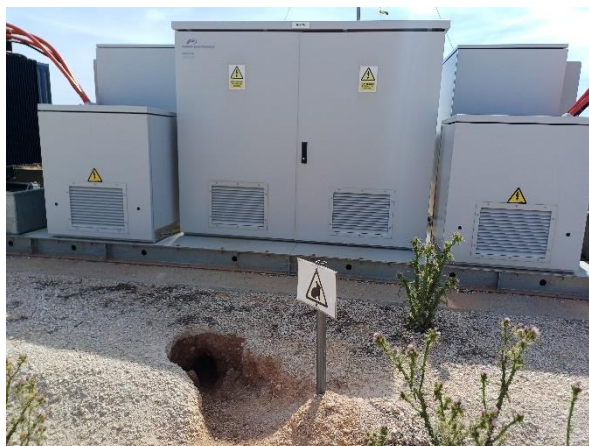
Imagen 13. Madriguera bajo uno de los centros de transformación
