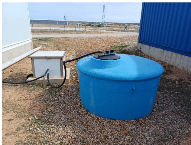
Imagen 2. Depósito para el almacenamiento de agua con destino a los aseos existentes en el edificio de O&M
