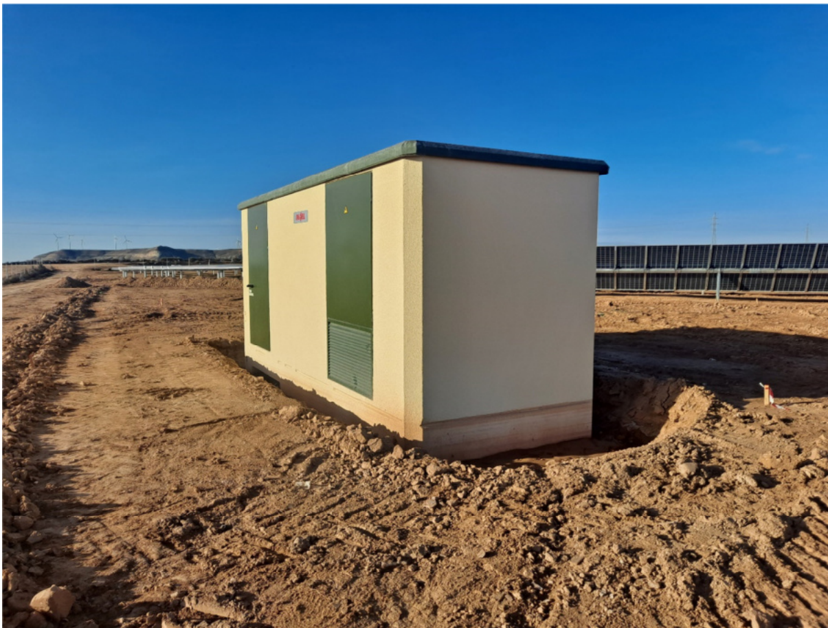
Figura 4.2. Uno de los dos centros de transformación colocados
