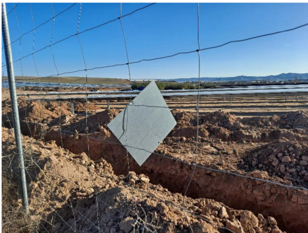
Figura 8.20. Placa con un solo punto de anclaje observada en el extremo noroccidental del vallado
