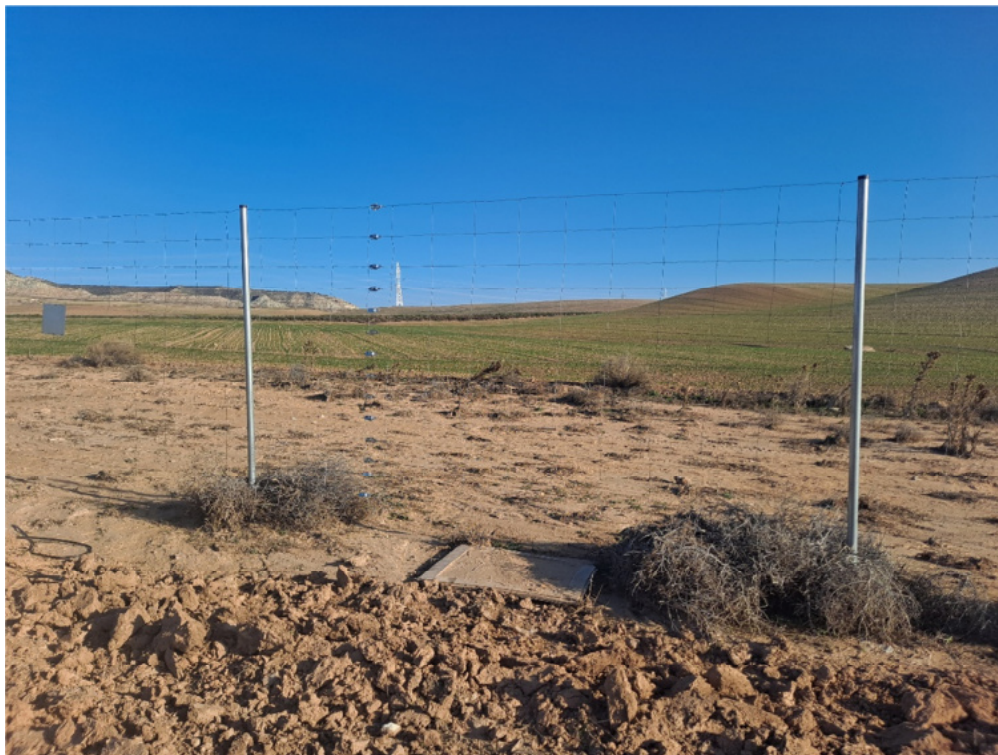
Figura 8.7. Placa ausente en uno de los vanos del vallado
