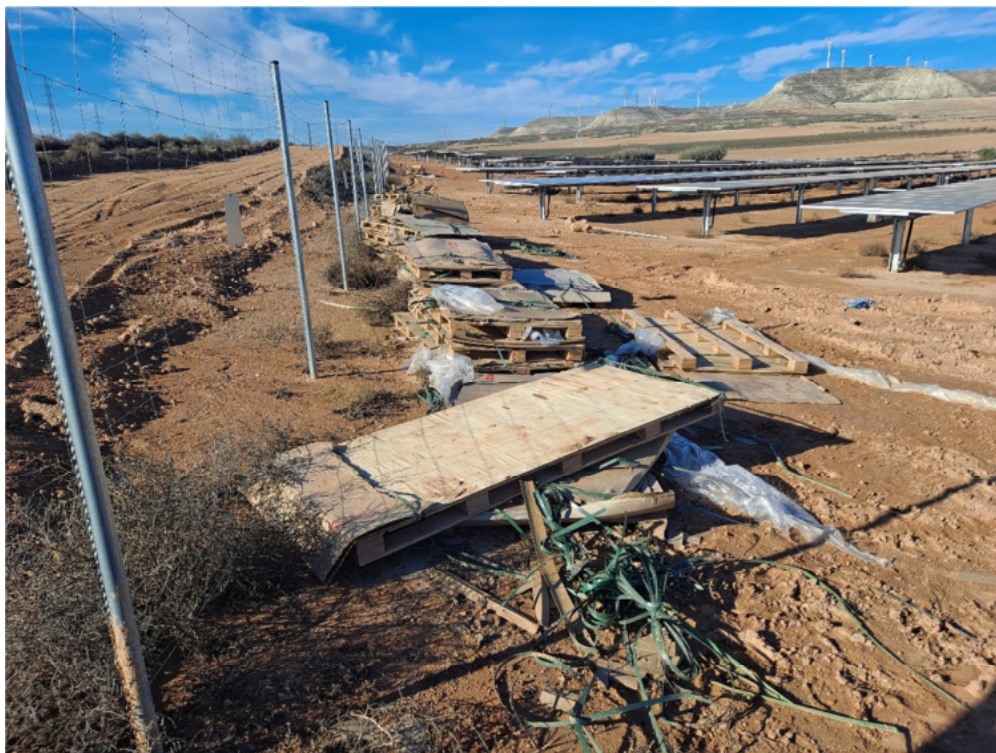
Figura 8.3. Residuos acumulados junto al vallado, el 27-11-2024
