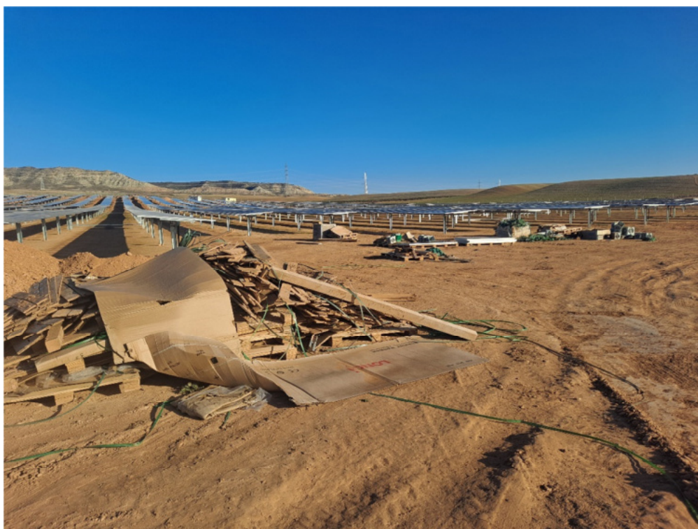
Figura 8.12. Nueva acumulación de residuos observada el 18-12-2024
