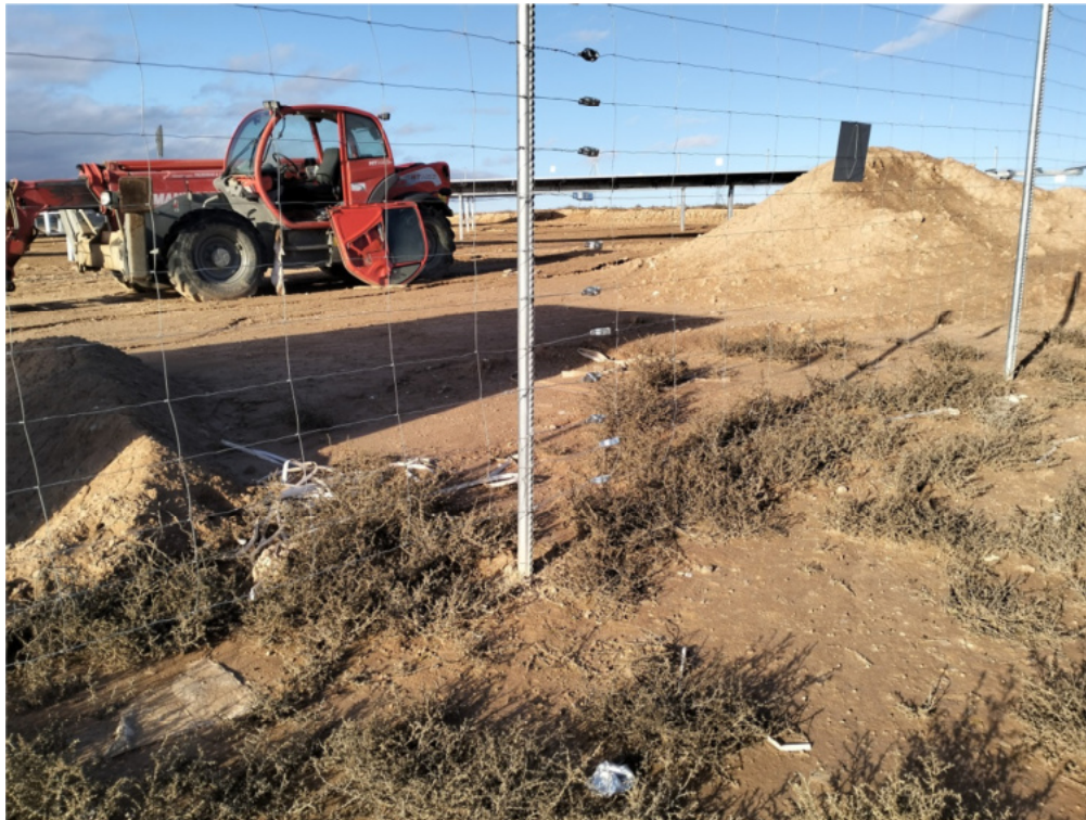
Figura 8.13. Tramo del vallado en la esquina norte que fue desmontado y ha sido cerrado. Presencia de residuos dispersos por interior y exterior de la planta
