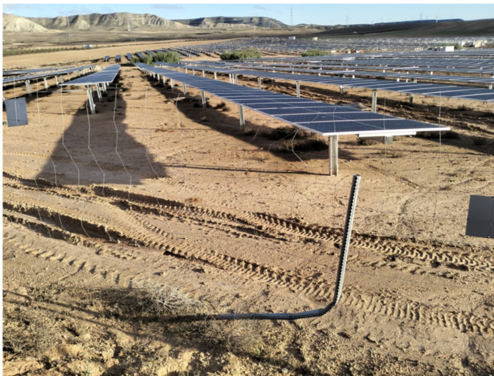
Figura 8.8. Poste doblado y vallado roto en el límite suroccidental de la parcela, dejando elementos punzantes peligrosos para la fauna
