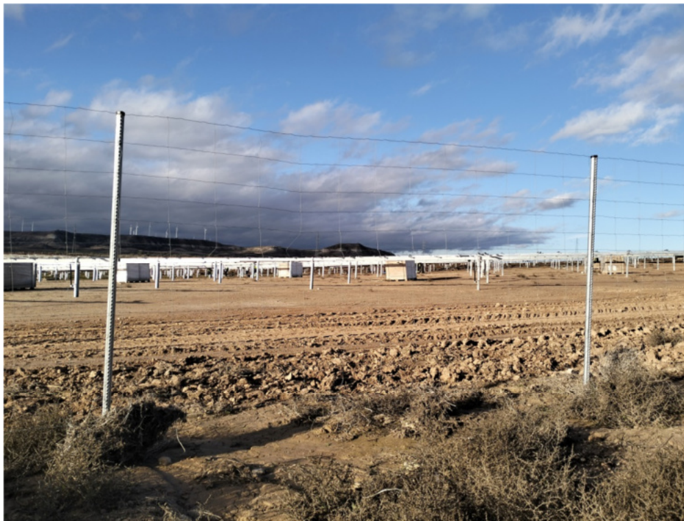
Figura 8.7. Vano del vallado sin placa
