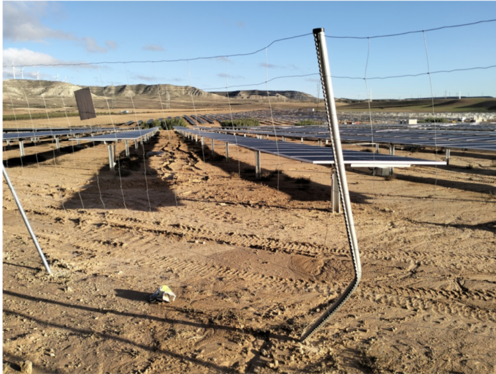
Figura 8.9. Segundo poste doblado y vallado roto en el límite suroccidental de la parcela, dejando elementos punzantes peligrosos para la fauna
