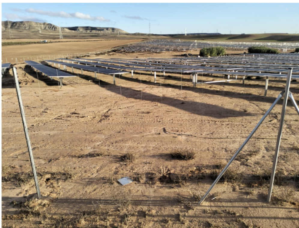
Figura 8.6. Vano del vallado sin placa
