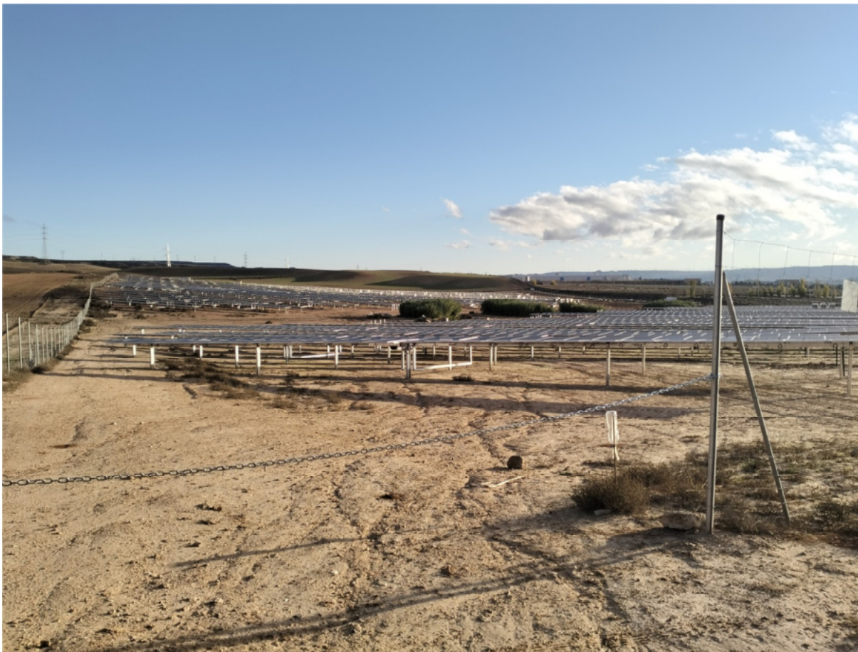
Figura 4.2. Aspecto de la parcela a fecha 31-10-2024, con placas colocadas en la mitad sur de la planta.
