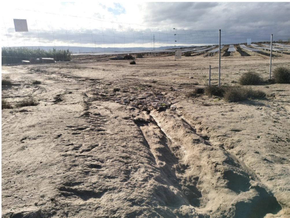
Figura 8.10. Reguero en el extremo noroeste de la parcela, que puede producir descalces en los postes del vallado
