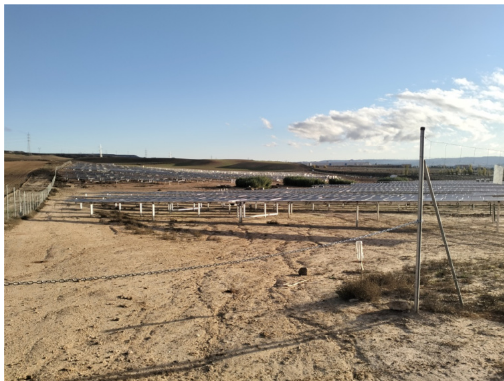
Figura 8.2. Aspecto de la planta el 31-10-2024. Colocación de placas en la mitad sur de la planta
