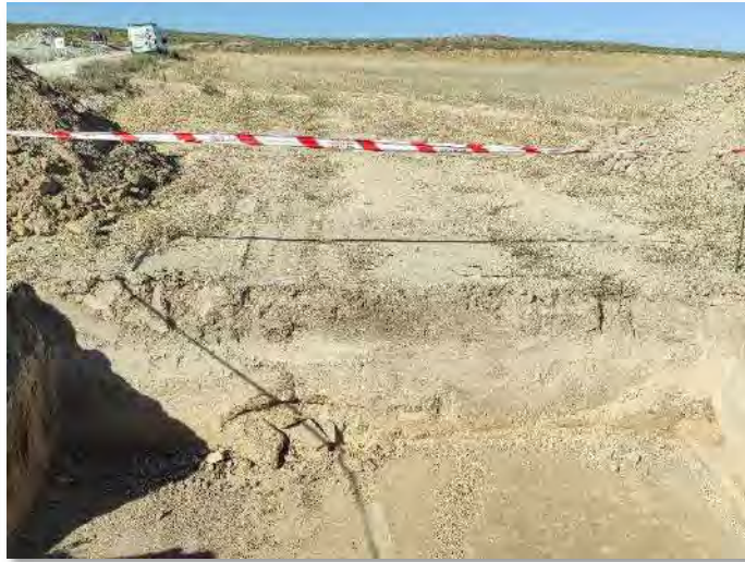
Fot 3-5. Excavación de cámaras y cruces a lo largo de la zanja de evacuación de la PFV Mitra.
