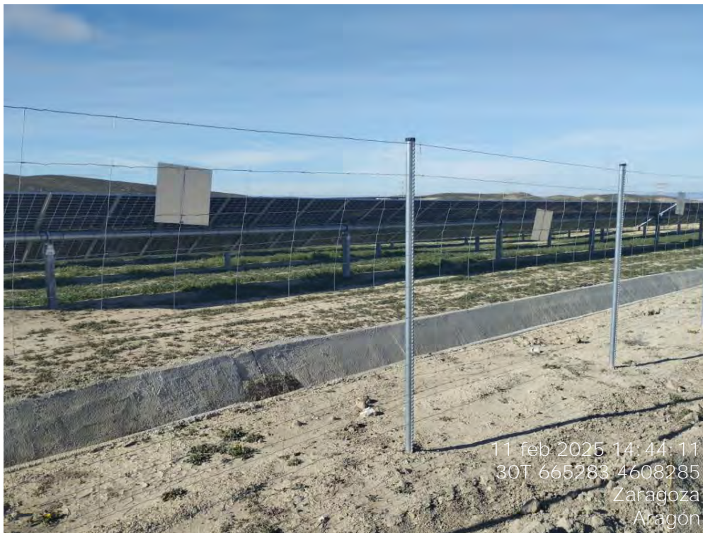
Ilustración 16. Cerramiento perimetral permeable a la fauna con placas metálicas
