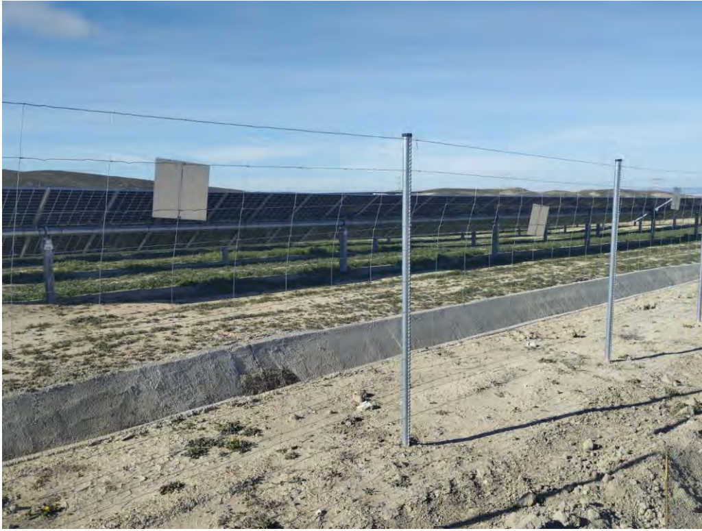
Ilustración 4. Placas metálicas anticolidión de avifauna instaladas en el vallado cinagético
