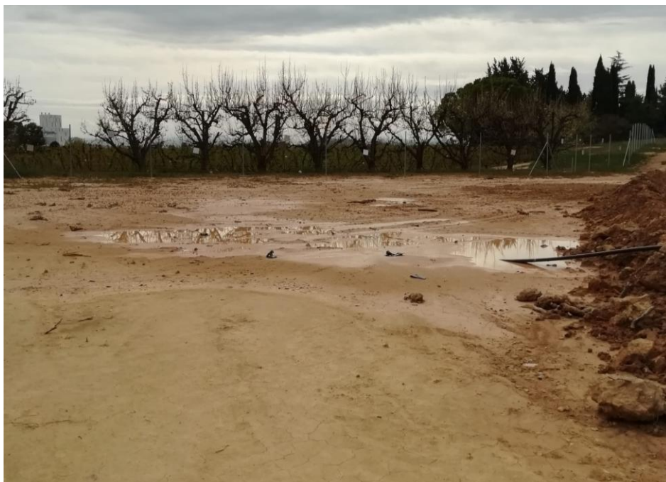
Imagen 4: Encharcamiento del terreno.
