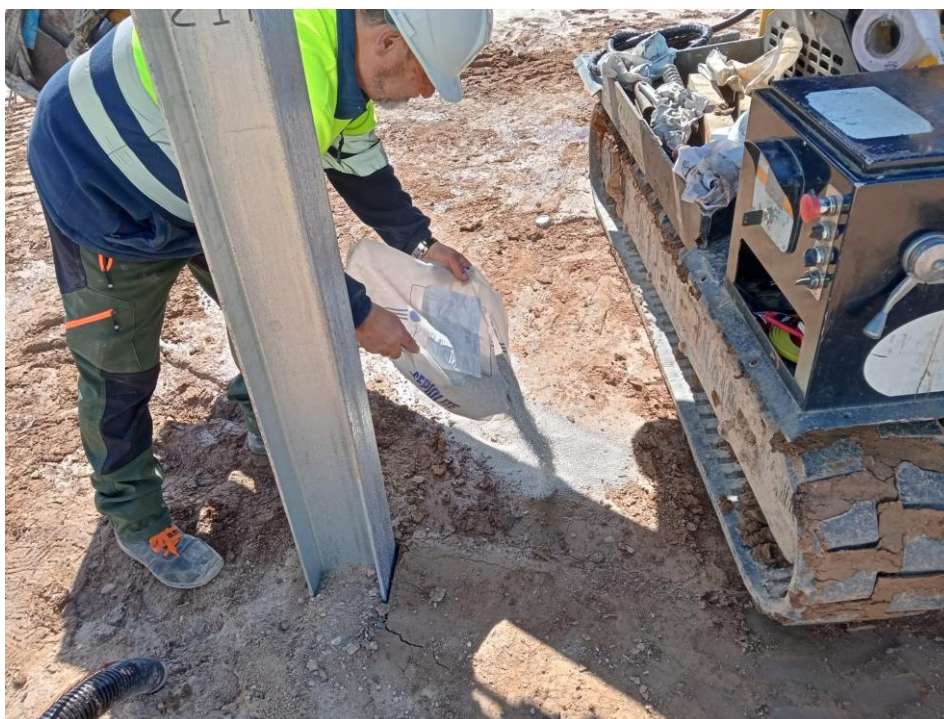
Imagen 2: Recogida de líquido contaminante procedente de maquinaria
