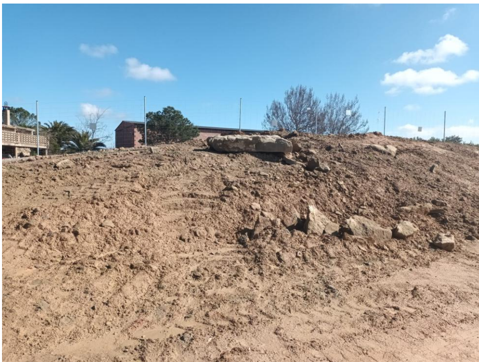
Imagen 3: Erosión de un talud dentro de la obra.
