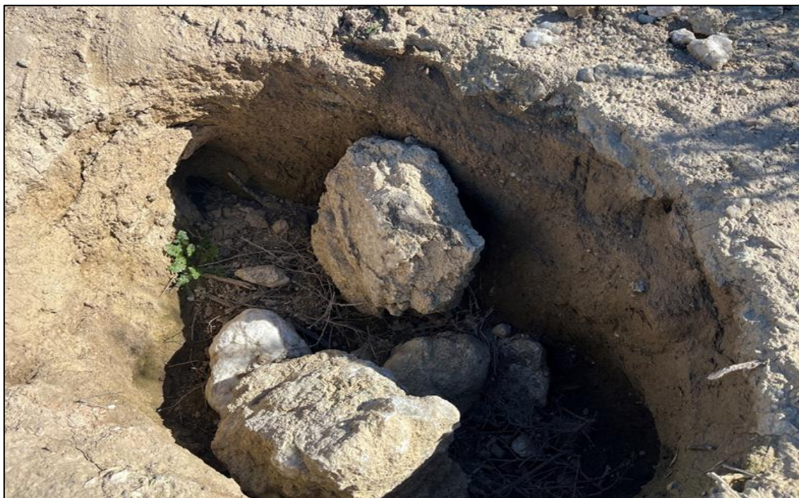
Fotografía 10. Vencimiento de tierra en el camino de acceso. Febrero 2024.
