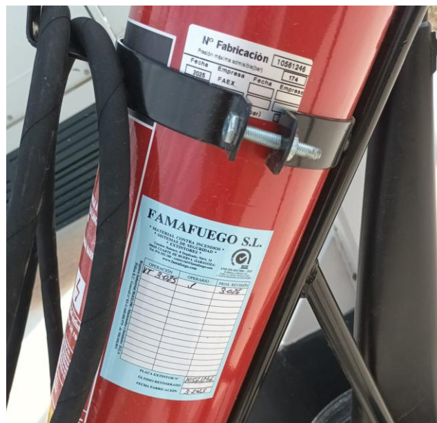
Extintores en regla
