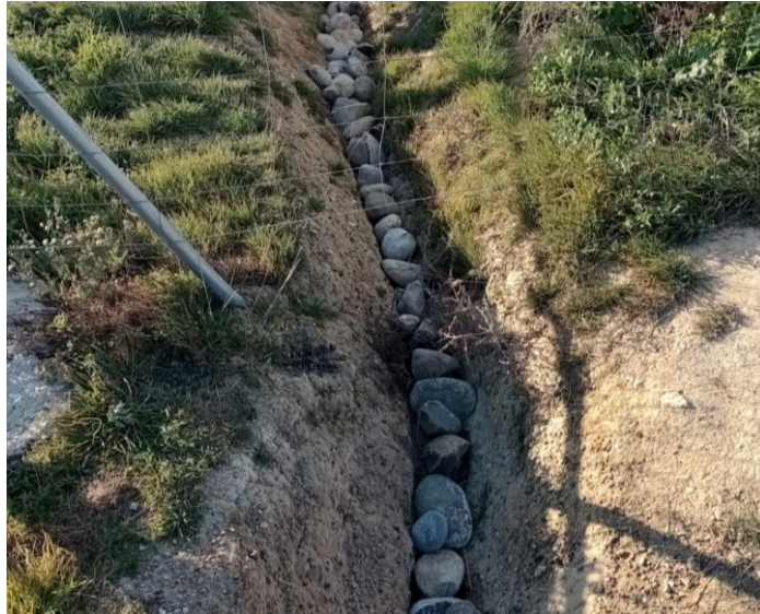
Erosión junto a la entrada de la parcela, dejando al descubierto el aviso de cableado eléctrico.
