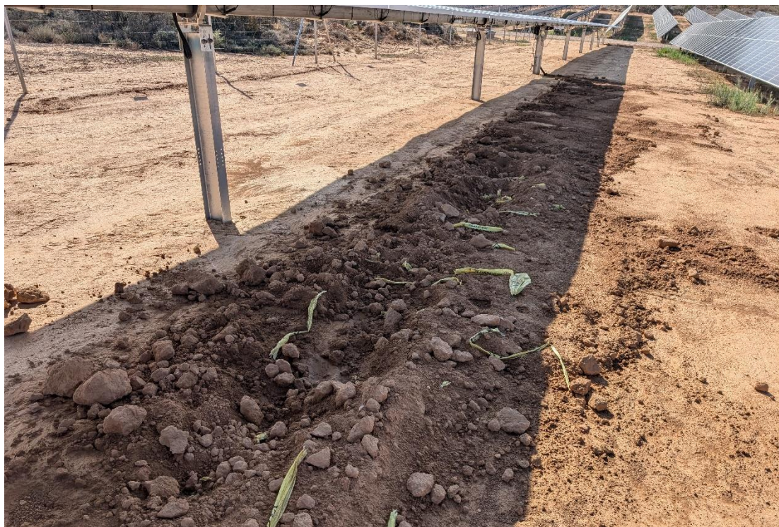
Foto 20. Restos plásticos por desmantelamiento de cableado en zona de sustitución de paneles montados sobre estructura fija por seguidores
