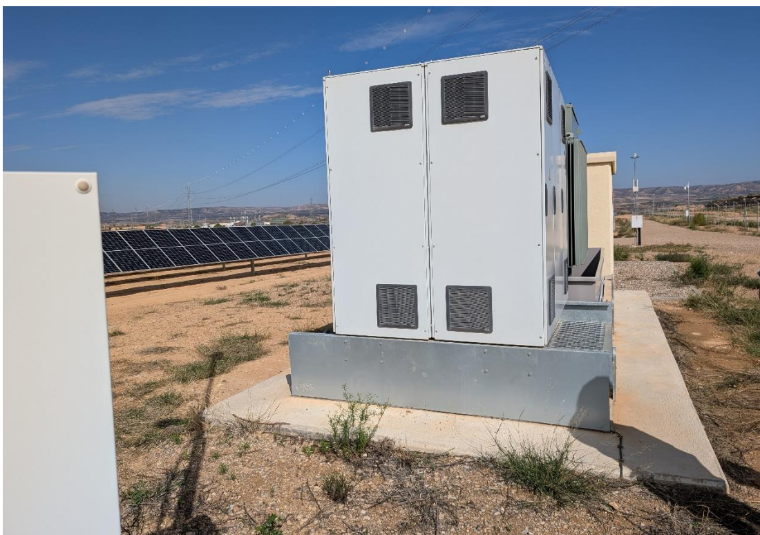
Foto 6. Instalaciones del Centro de Transformación de la planta fotovoltaica
