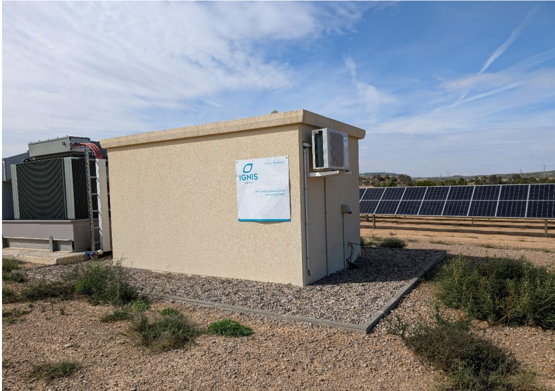
Foto 7. Instalaciones del Centro de Transformación de la planta fotovoltaica
