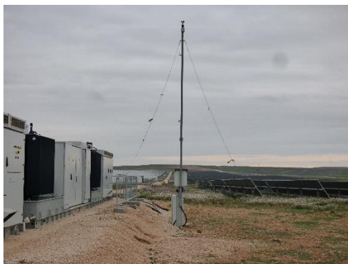
Imagen 7. Periódicamente el promotor revisa las cintas de plástico instaladas en los tensores de las torres anemométricas cuya finalidad es incrementar la visibilidad de los mismos por parte de la avifauna
